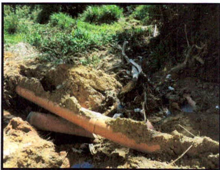
Figura 08 - Tubulação desprotegida ( Fonte: o autor ).
