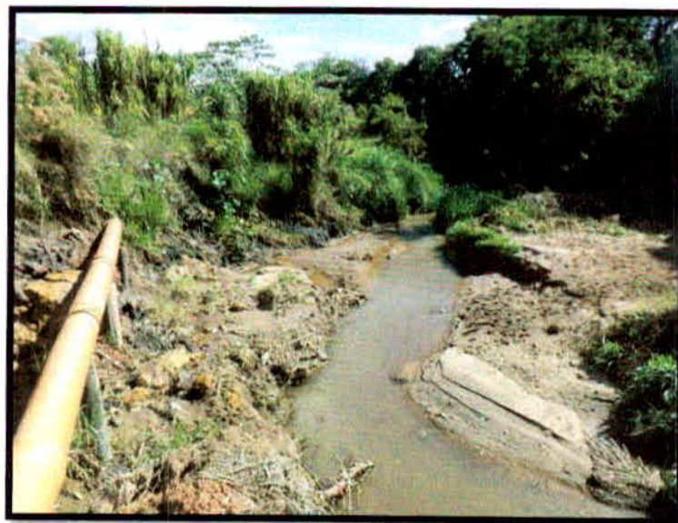
Figura 02 - 1º trecho da tubulação sem proteção (Fonte: o autor).
