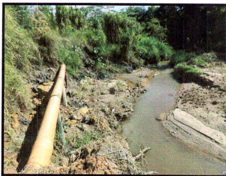
Figura 05 - Proximidade da rede junto ao córrego (Fonte: o autor).
