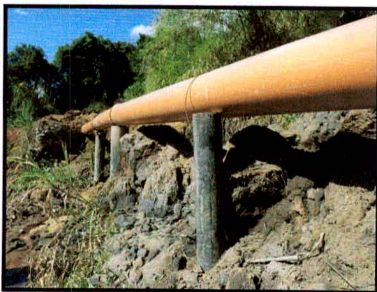
Figura 06 - Solo prejudicando a estrutura (Fonte: o autor).
