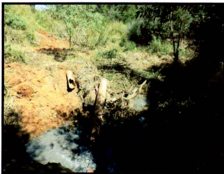
Figura 07 – Erosão do solo danificando a rede (Fonte: o autor).
