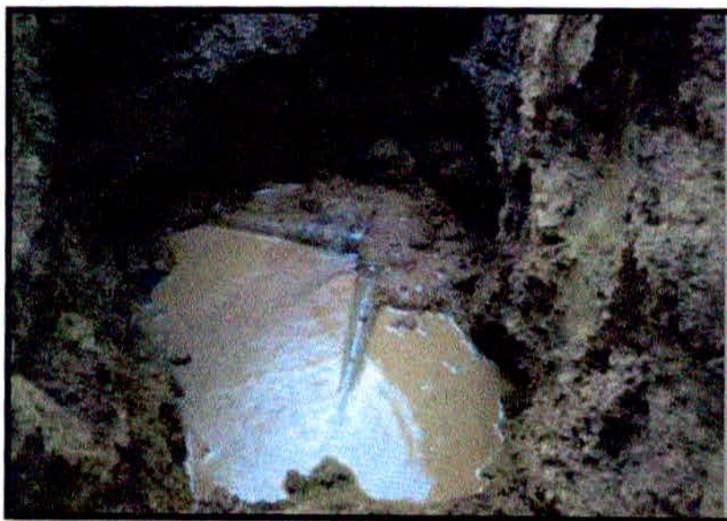
Figura 09 - Vazamento de rede não aflorante
