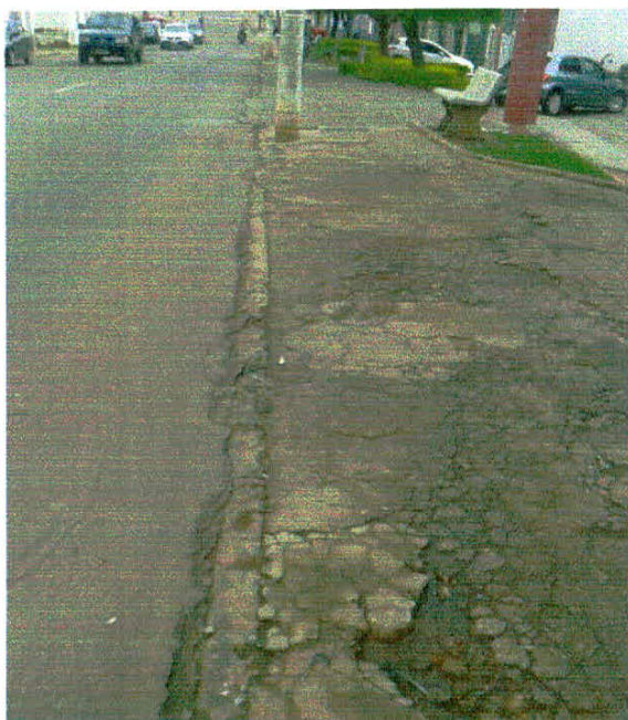
Figura 15: Falta de meio-fio e desgaste da calçada
