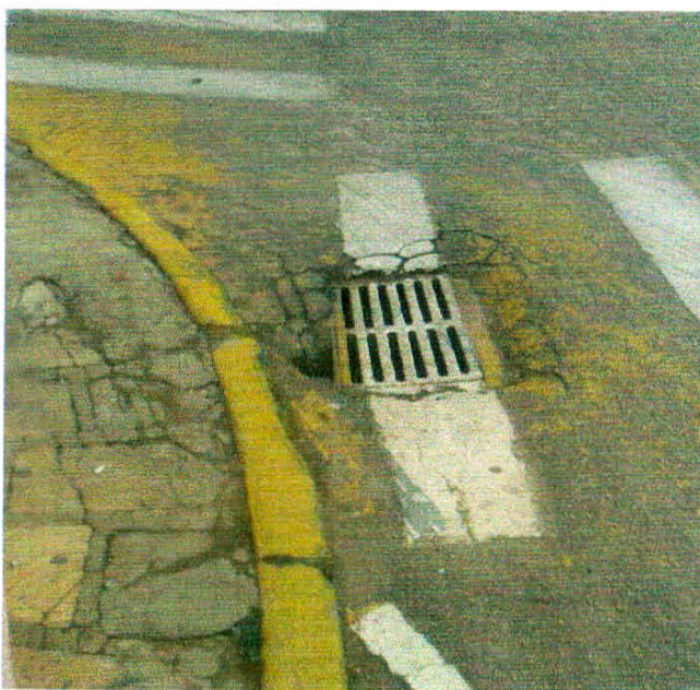
Figura 12. Boca de lobo localizada em local inadequado.
