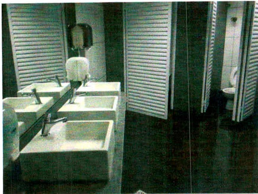
Foto 4 - Banheiro (Cooper Standard)
