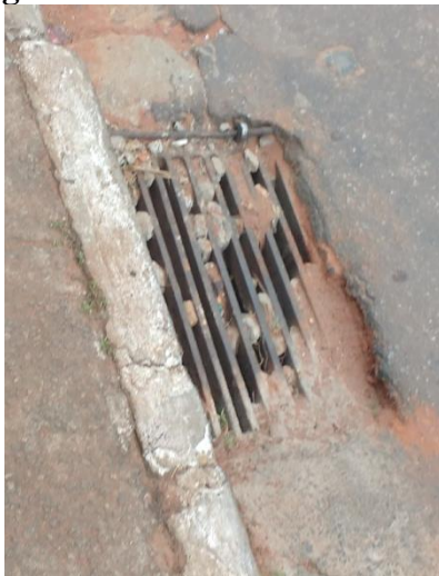
Figura 11: Boca de lobo obstruída
