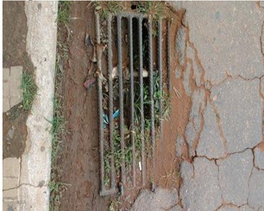
Figura 12: Boca de lobo obstruída.
