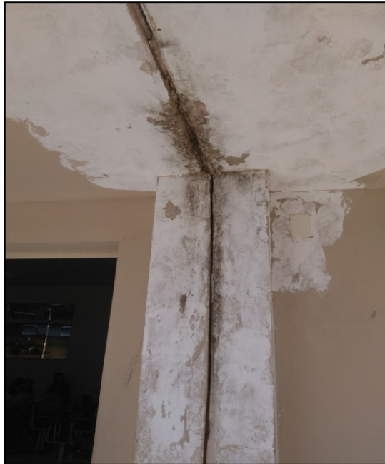
Figura 12– Infiltração no prédio das salas de aula.
