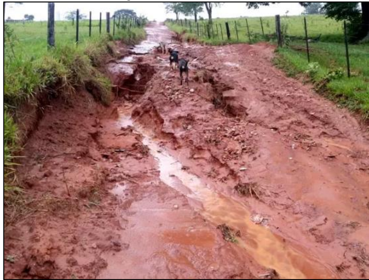
Figura 6 - Erosão em ravina
