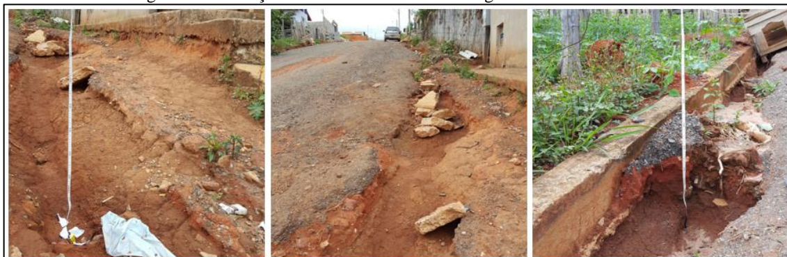
Figura 48 - Medição de defeitos - Rua Alair Jorge Carvalho - Trecho 02
