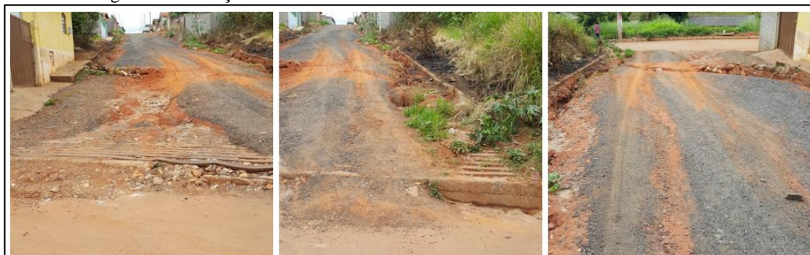
Figura 46 - Medição de defeitos - Rua Sebastião Oliveira de Guimarães - Trecho 01
