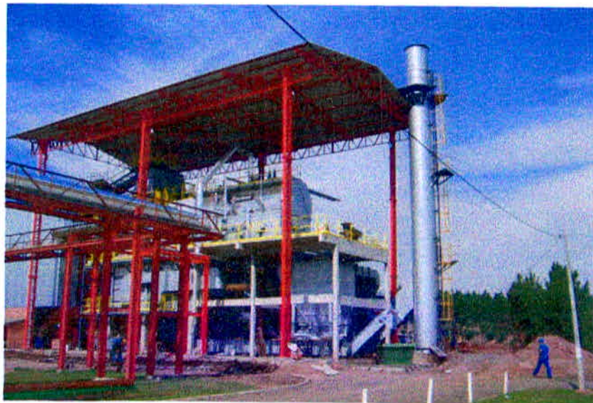
Foto 14: Gerador de Vapor Modelo B Fonte: A Empresa Pesquisada
