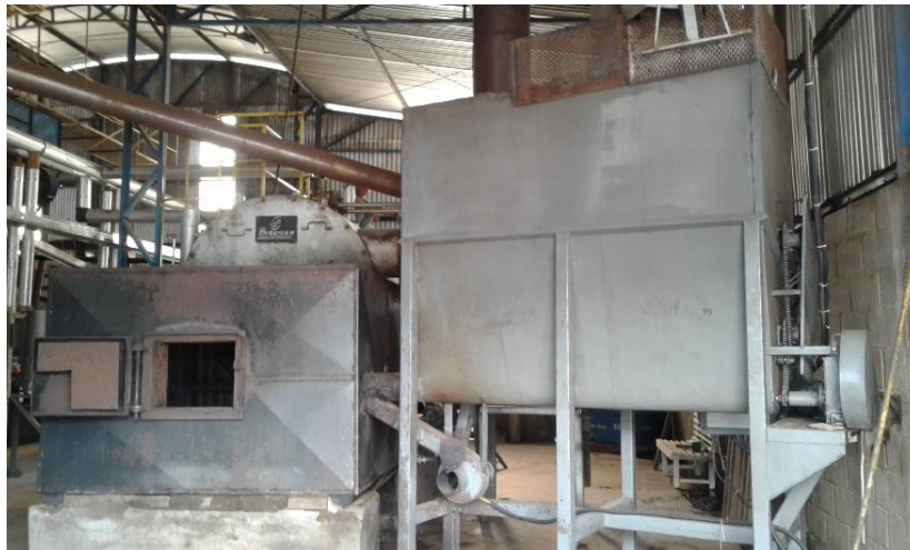
Figura 06: Vista da frente da Caldeira. Fonte: O Autor, 2019.
