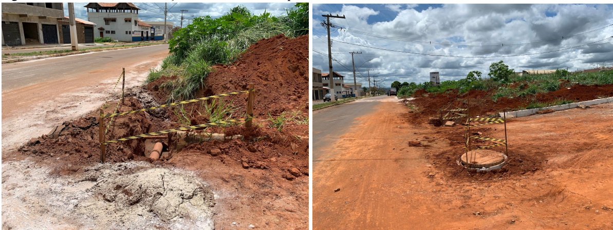
Figuras 14 e 15 - A falta de calçadas e meio-fio comprometem a infraestrutura do bairro.
