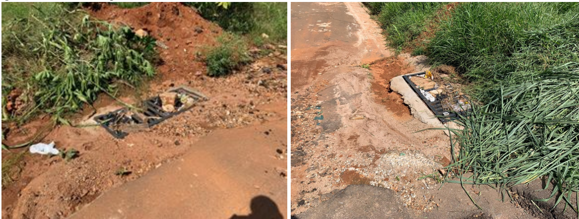
Figuras 12 e 13 - Entupimento das bocas de lobo.
