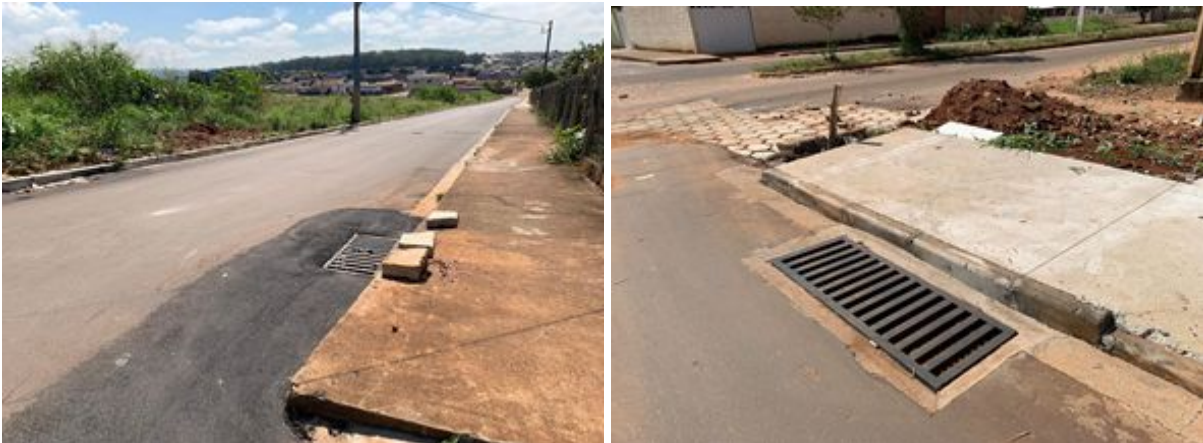
Figura 10 e 11 - Algumas vias com implementação de boca de lobo.
