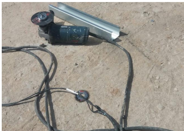
Figura38: Equipamentos no local inadequado
