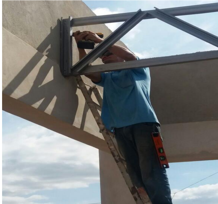
Figura 35: Falta de EPI'S
