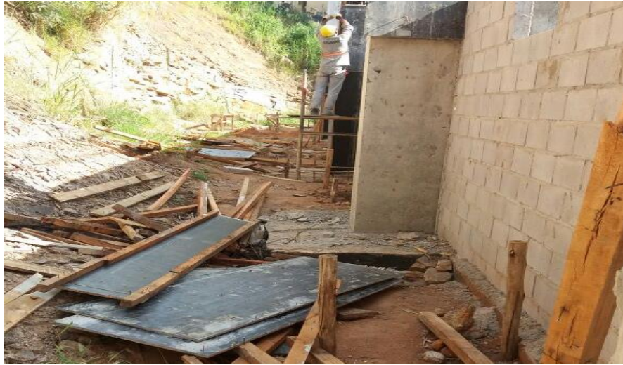
Figura 34: Entulhos no canteiro de obras
