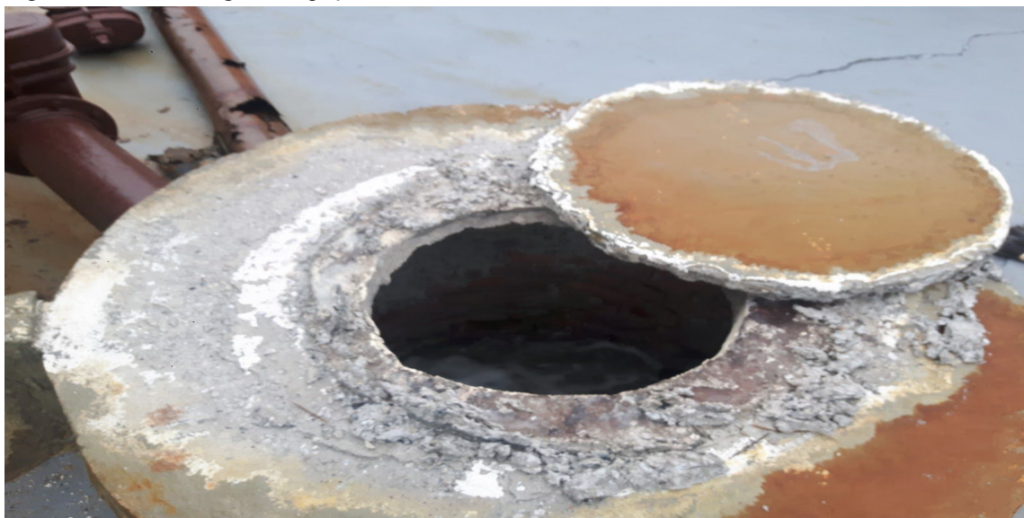
Figura 02 - Efeitos do gás num poço de visita
