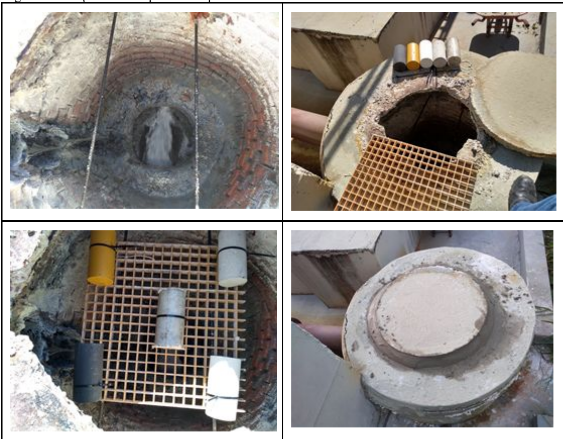
Figura 03 - Poço de visita que servirá para o confinamento
