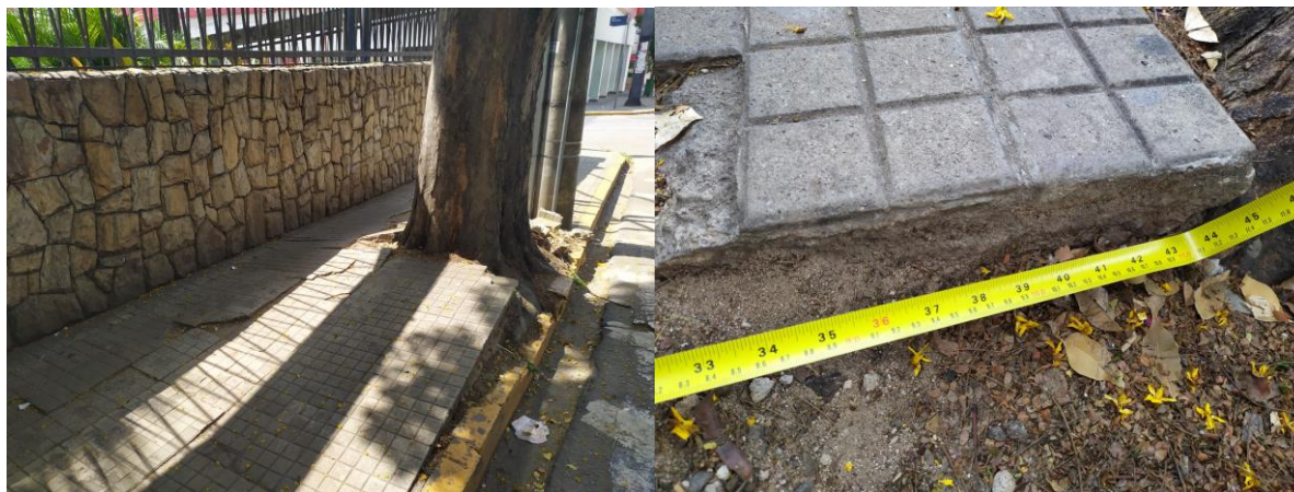
Figura 10 - Danificação de calçada e largura de vão
