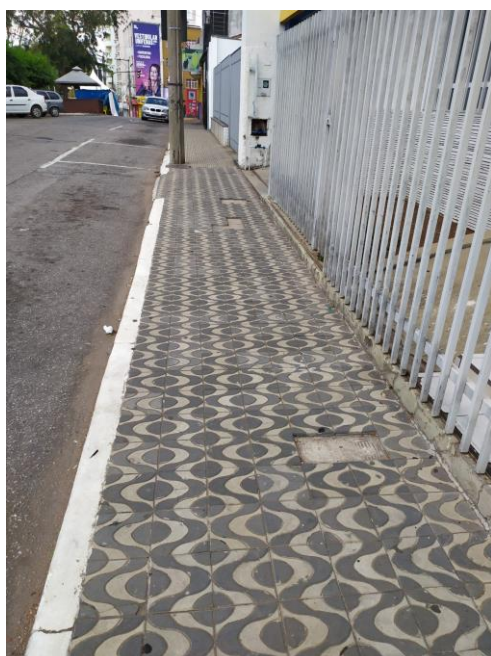
Figura 14 - Danificação de calçada
