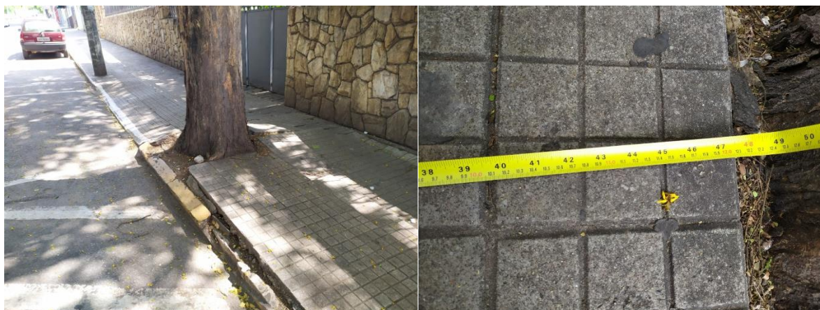
Figura 11 - Danificação de calçada e largura de vão
