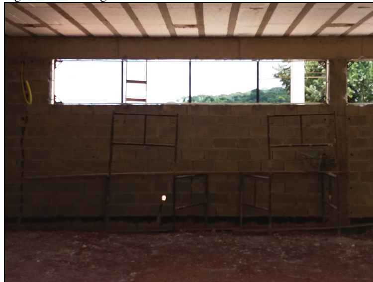
Figura 22 - Montagem incorreta de andaimes fachadeiros
