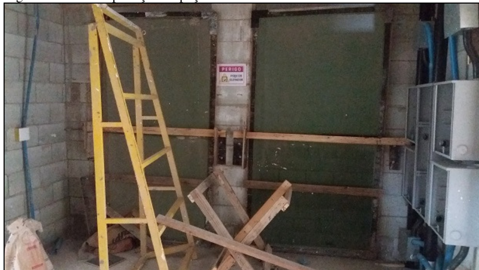
Figura 23 - Tela de proteção do poço do elevador
