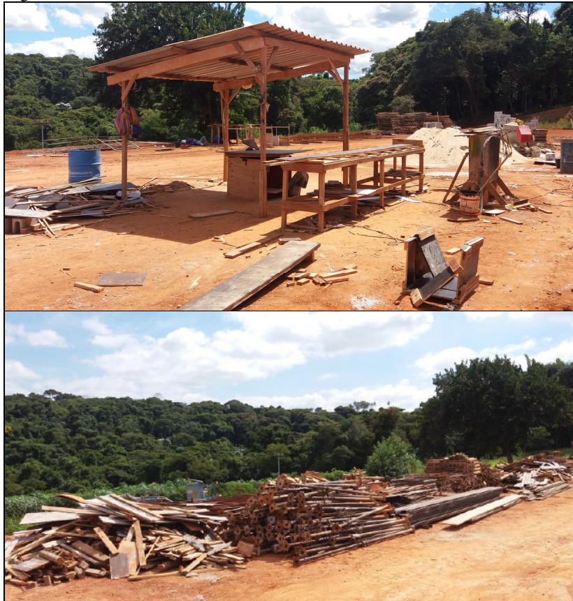
Figura 6 - Armazenamento incorreto de materiais
