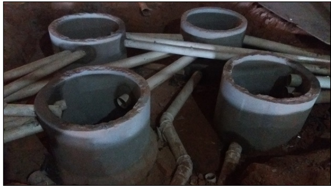
Figura 28 - Instalação sanitária predial
