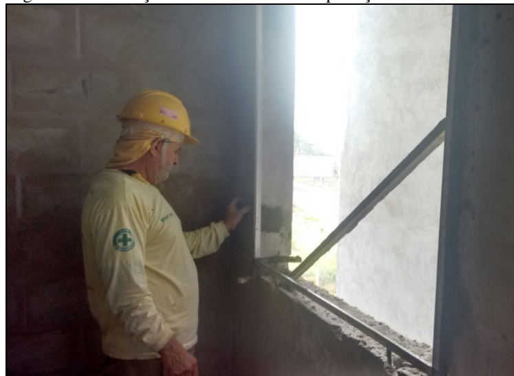
Figura 20 - Instalação do contramarco sem proteção
