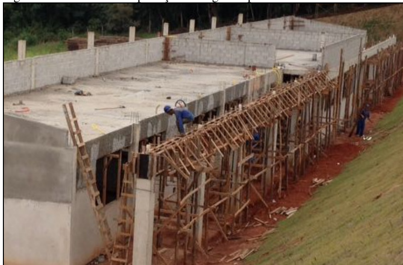
Figura 19 - Trabalho sem proteção no segundo pavimento
