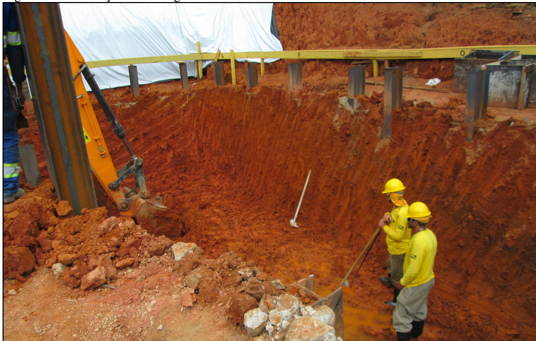
Figura 10 - Escavação com irregularidades
