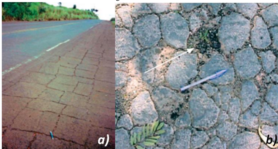
Figura 7 - Trincas em Bloco.
