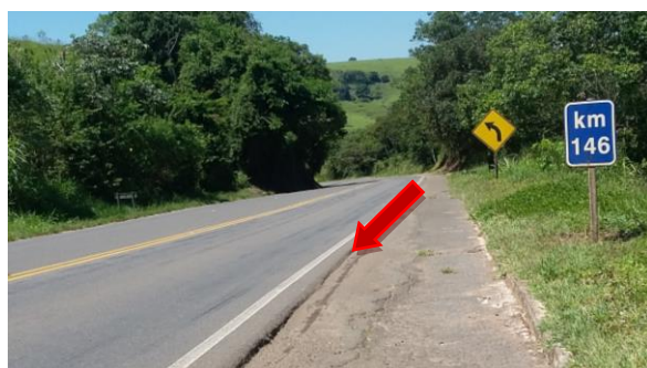
Desnível entre a Pista e o Acostamento
