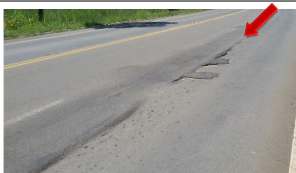
Escorregamento do Revestimento
