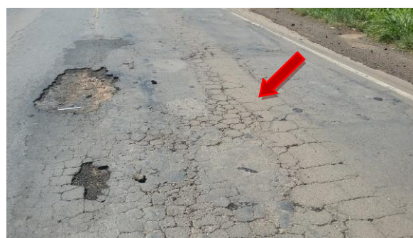
Trincas em Bloco
