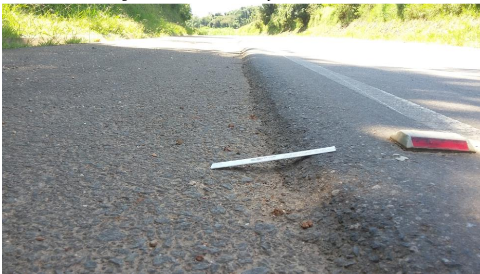
Figura 15 - Desnível entre a pista e acostamento.
