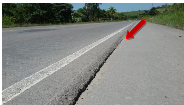
Desnível entre a Pista e o Acostamento
