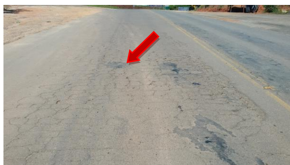
Trincas em Bloco
