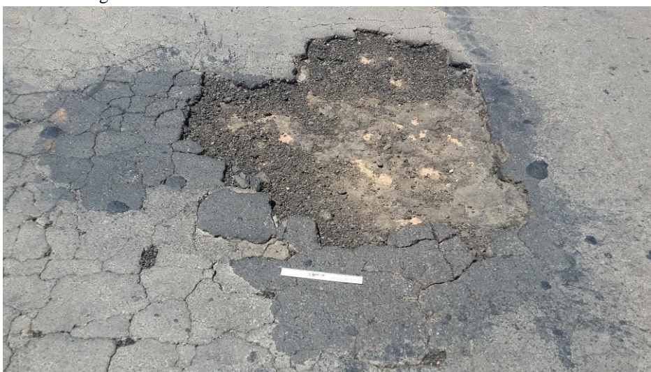
Figura 24 - Painela com nível de severidade alto – Km 147/km148.
