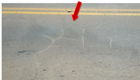
Trincas em Bloco
