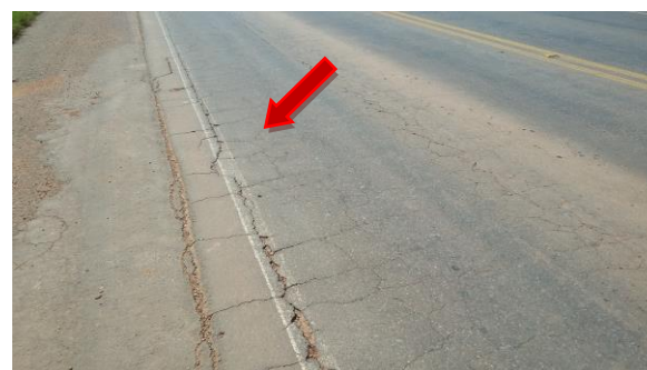
Trincas em Bloco
