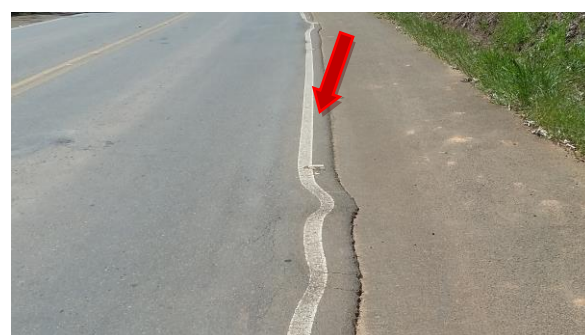
Escorregamento do Revestimento
