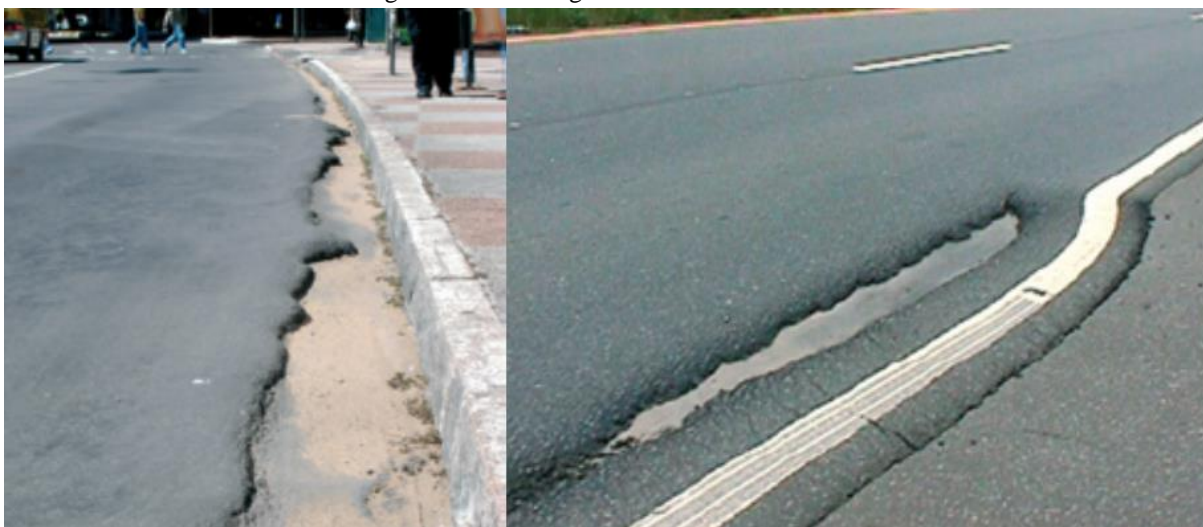
Figura 10 - Escorregamento do Revestimento.
