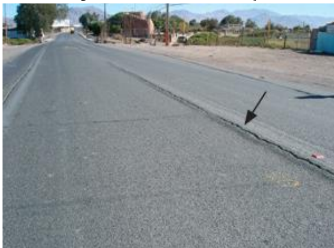
Figura 6 - Trincas Isoladas de Retração.
