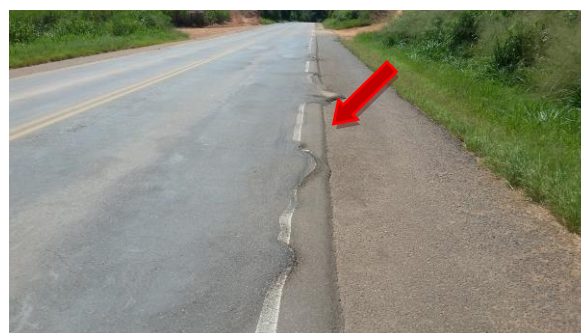
Escorregamento do Revestimento
