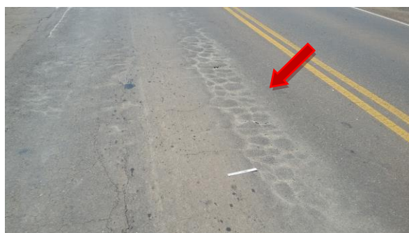
Trincas em Bloco
