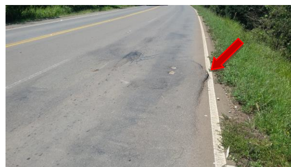
Escorregamento do Revestimento
