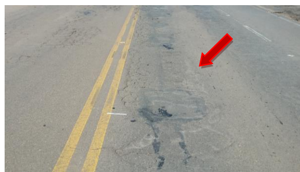
Afundamento nas trilhas de roda com trincamento por fadiga.
