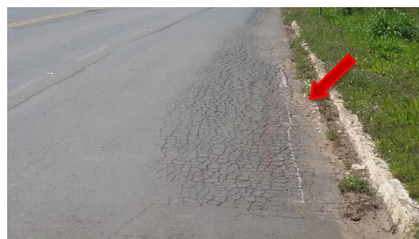
Trincas em Bloco
