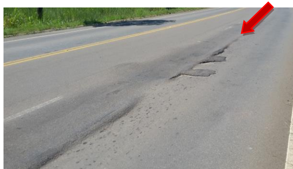
Escorregamento do Revestimento
