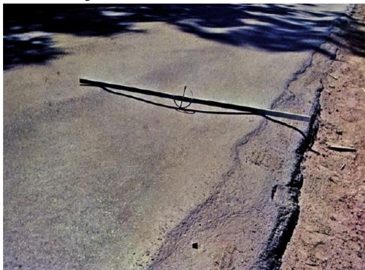
Figura 8 - Afundamento na trilha de roda.
