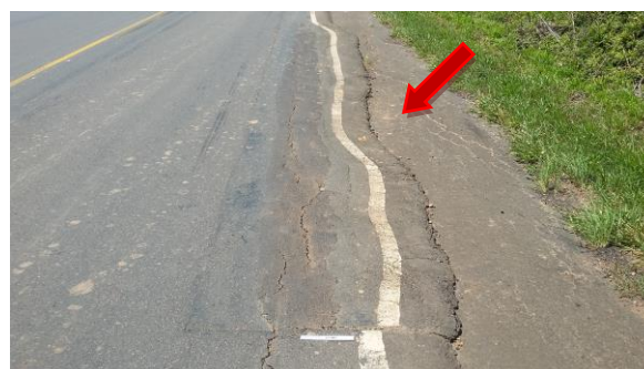
Escorregamento do Revestimento
