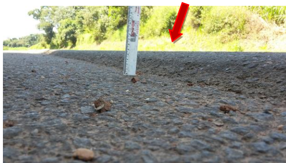
Desnível entre a Pista e o Acostamento
