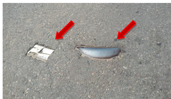
Recapeamento executado sem devida limpeza (sobre objetos)
