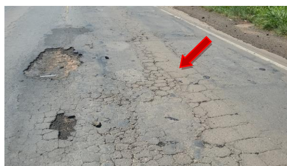
Trincas em Bloco
