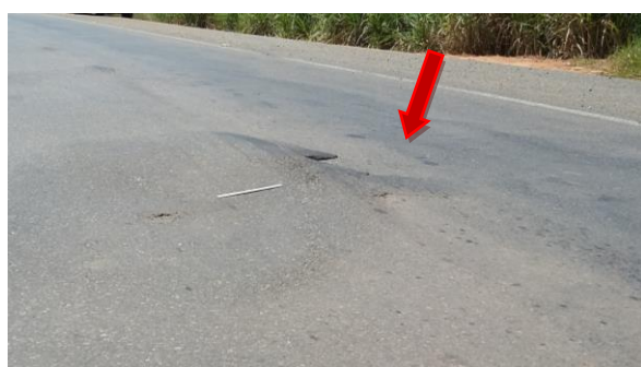
Escorregamento do Revestimento
