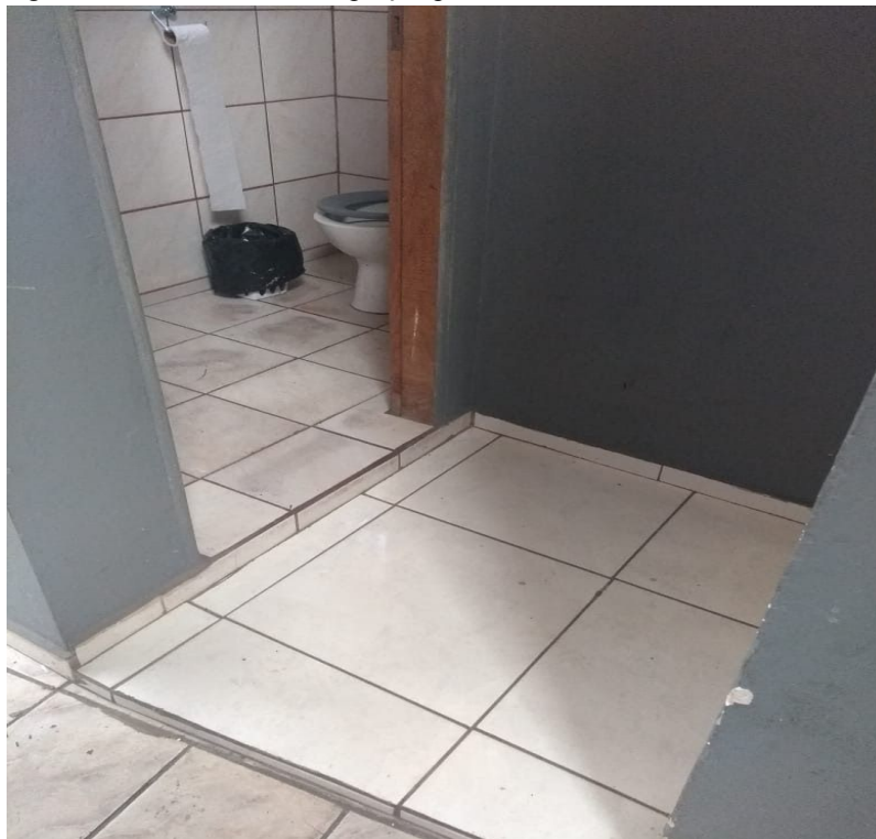
Figura 10 - Banheiro sem adaptação para PNE
