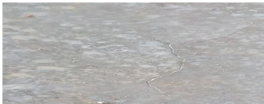
Fig. 06 – Interseção entre fissuras
