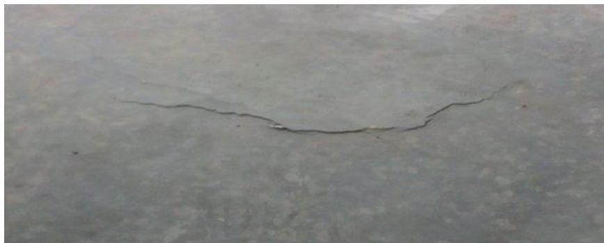
Fig. 05 – Primeira fissuras no piso já acabado
