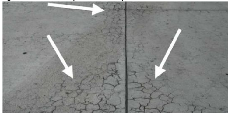
Figura 8 - Fissuras mapeadas em um pavimento de concreto.
