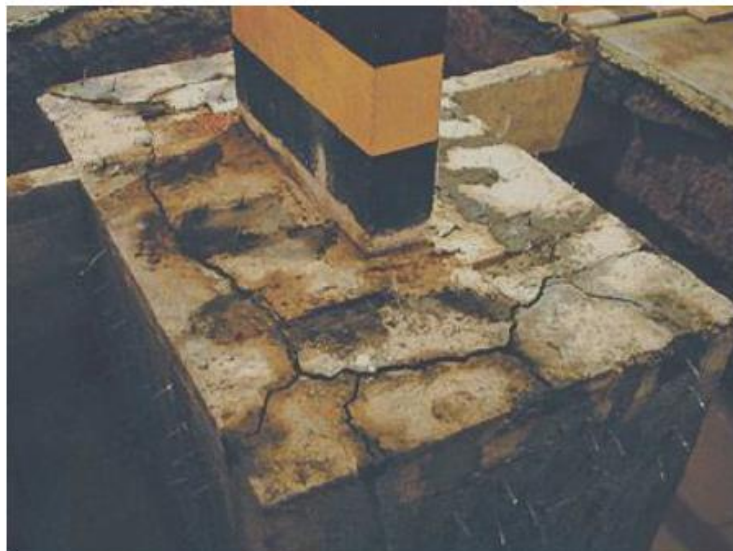
Figura 4 - Fissuração provocada pela RAA em bloco de fundação no Recife.
