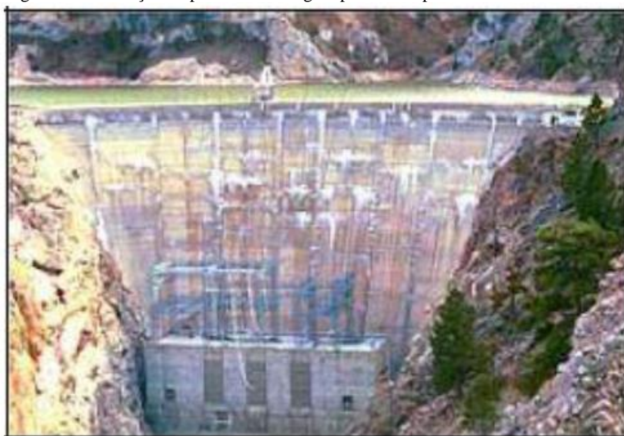
Figura 3 - Fissuração mapeada em barragem provocada pela RAA.
