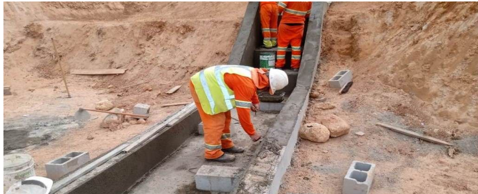
Figura 2 - Funcionário rebocando sem EPI (luva de látex) para rebocar a mesma drenagem.
