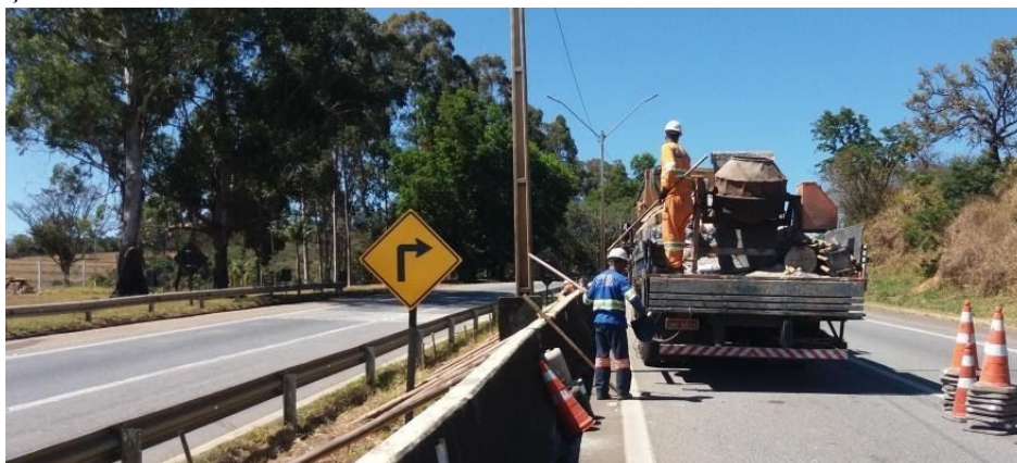
Figura 5 - Caminhão carroceria com os equipamentos que são utilizados na manutenção rodoviária.
