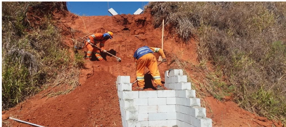
Figura 3 - Somente um funcionário usando EPI (cinturão de segurança) para realizar serviços em um talude.
