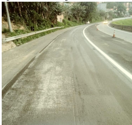
Figura 2 - Trincas interligadas com erosão “Jacaré” - JE
