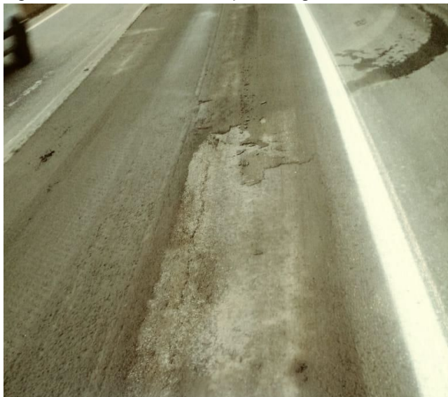
Figura 3 - Fissura com Exsudação do Ligante - FIEX
