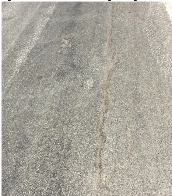
Figura 4 - Trincas Isoladas - Long. - Longas TLL
