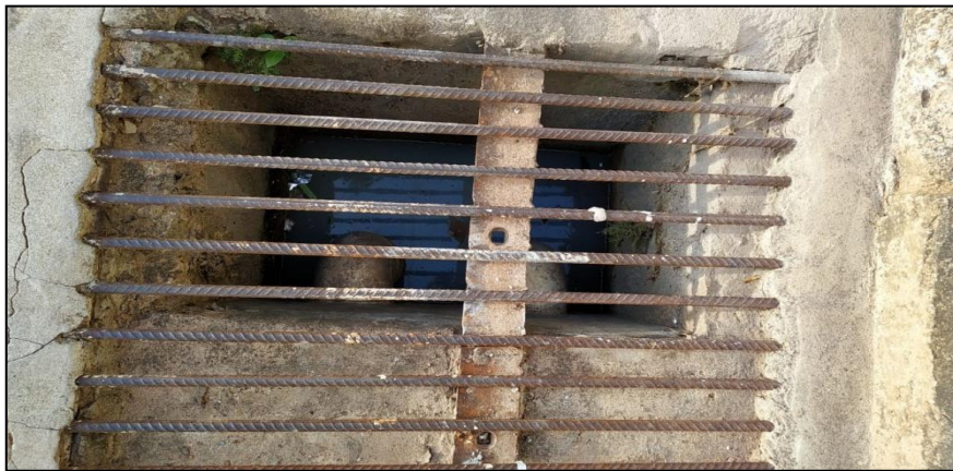
Figura 7: Boca de lobo entupida.
