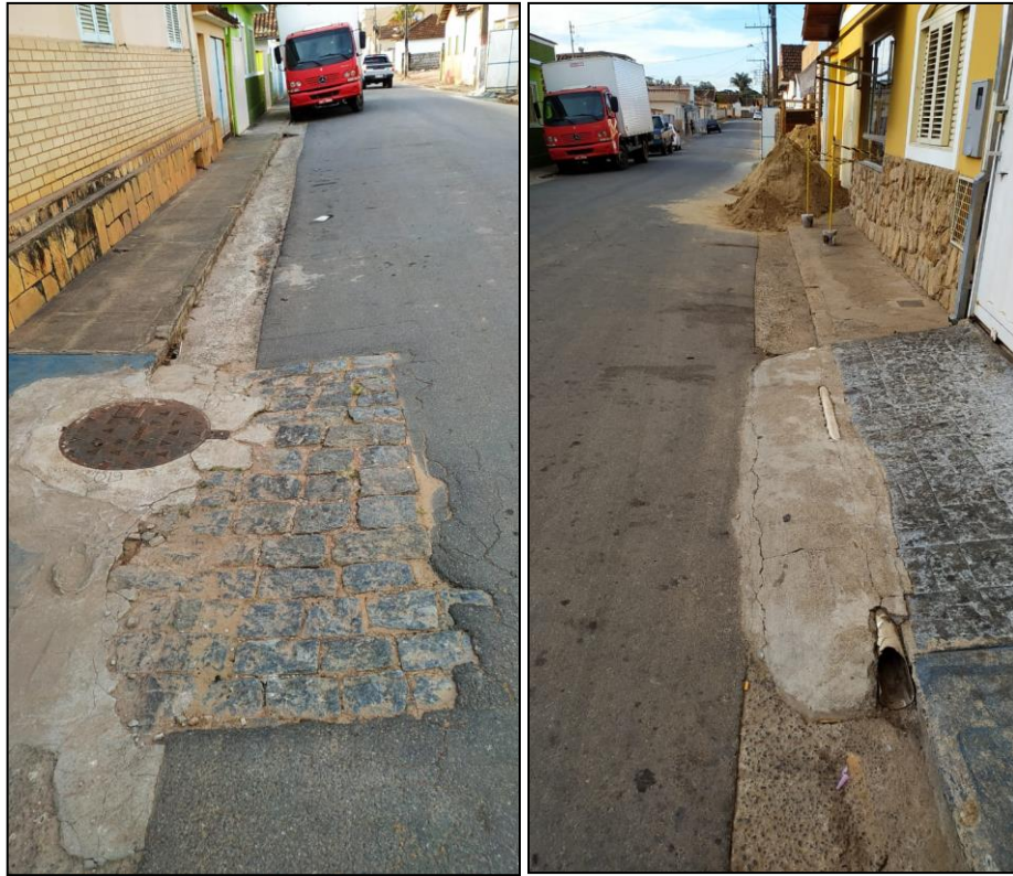
Figura 8: Sarjeta quebrada e elevação para garagem.
