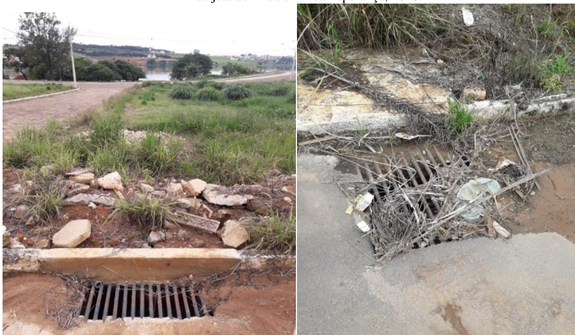
Figura 31 e 32: Aspectos das Estruturas existentes na microdrenagem. Bocas de lobo gradeadas sem sarjeta definida em Boa Esperança, 2020.
