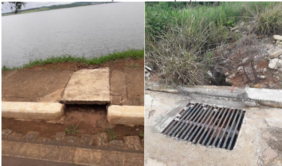
Figura 33 e 34: Aspectos das Estruturas existentes na microdrenagem. Bocas de lobo gradeadas sem sarjeta definida em Boa Esperança, 2020
