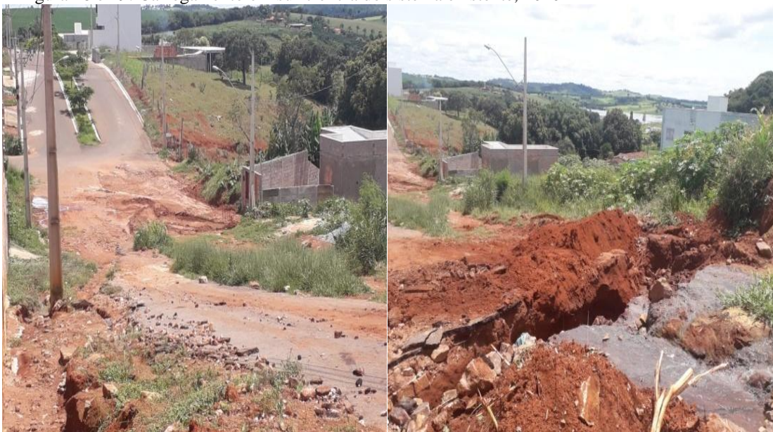
Figura 48 e 49: Carregamento e insuficiência do sistema existente, 2020
