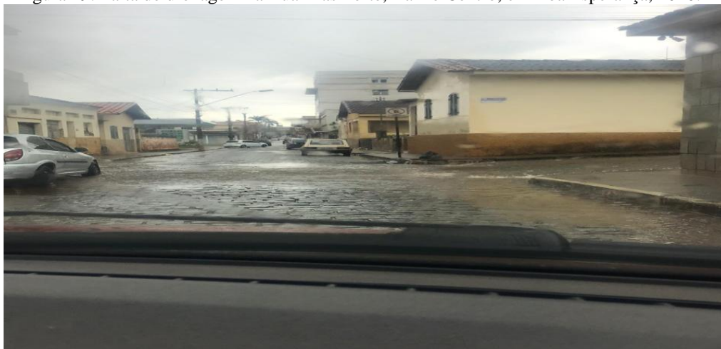
Figura 19: Falta de drenagem na Rua Bias Forte, Bairro Centro, em Boa Esperança, 2020.
