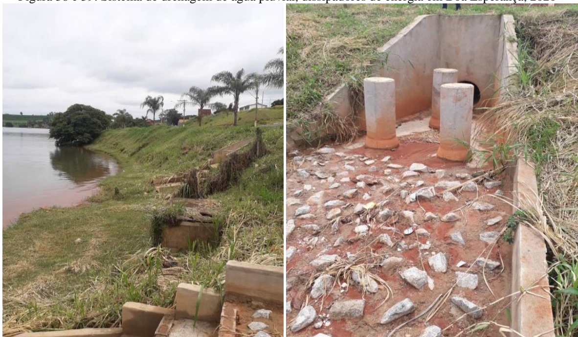
Figura 38 e 39: Sistema de drenagem de água pluvial, dissipadores de energia em Boa Esperança, 2020
