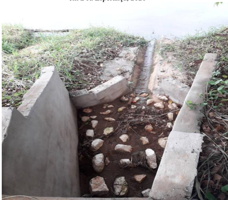
Figura 40: Sistema de drenagem de água pluvial, dissipadores de energia em Boa Esperança, 2020
