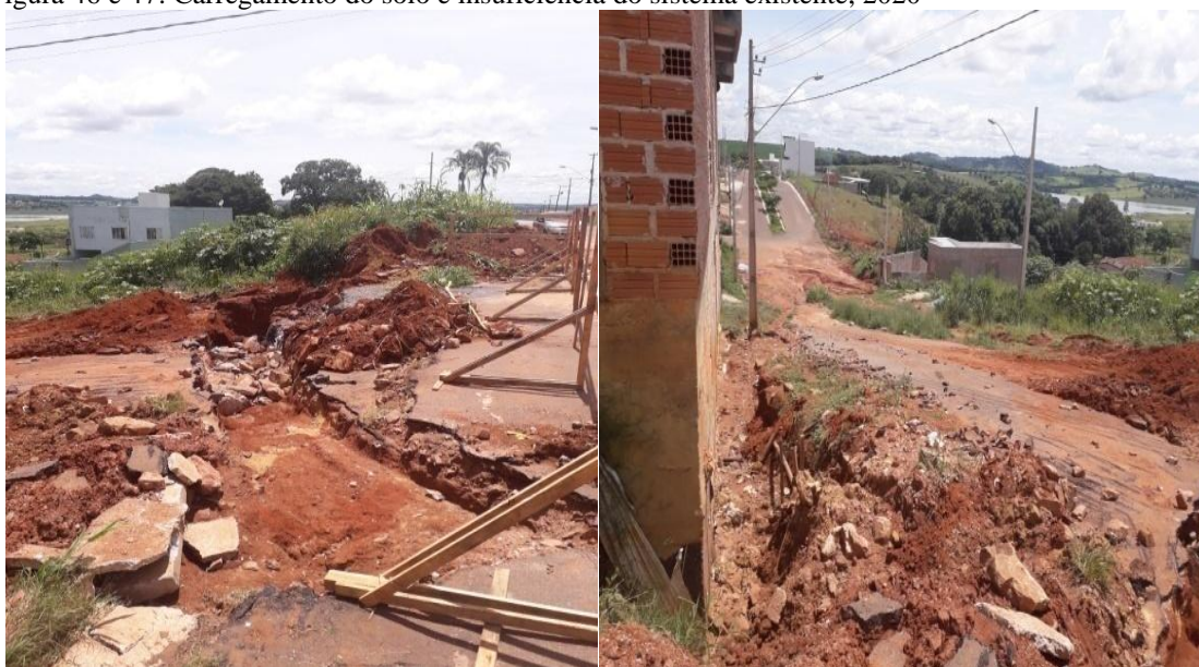
Figura 46 e 47: Carregamento do solo e insuficiência do sistema existente, 2020
