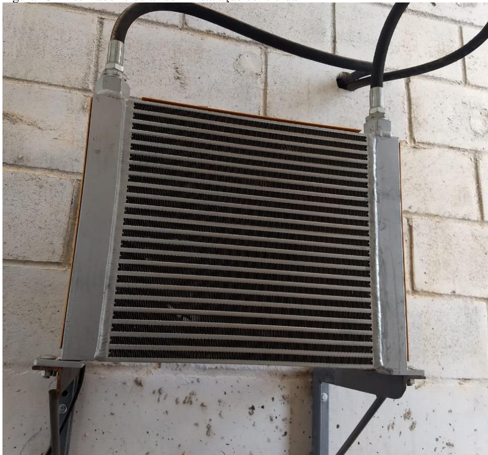
Figura 15 - Resfriador óleo-ar com instalação concluída
