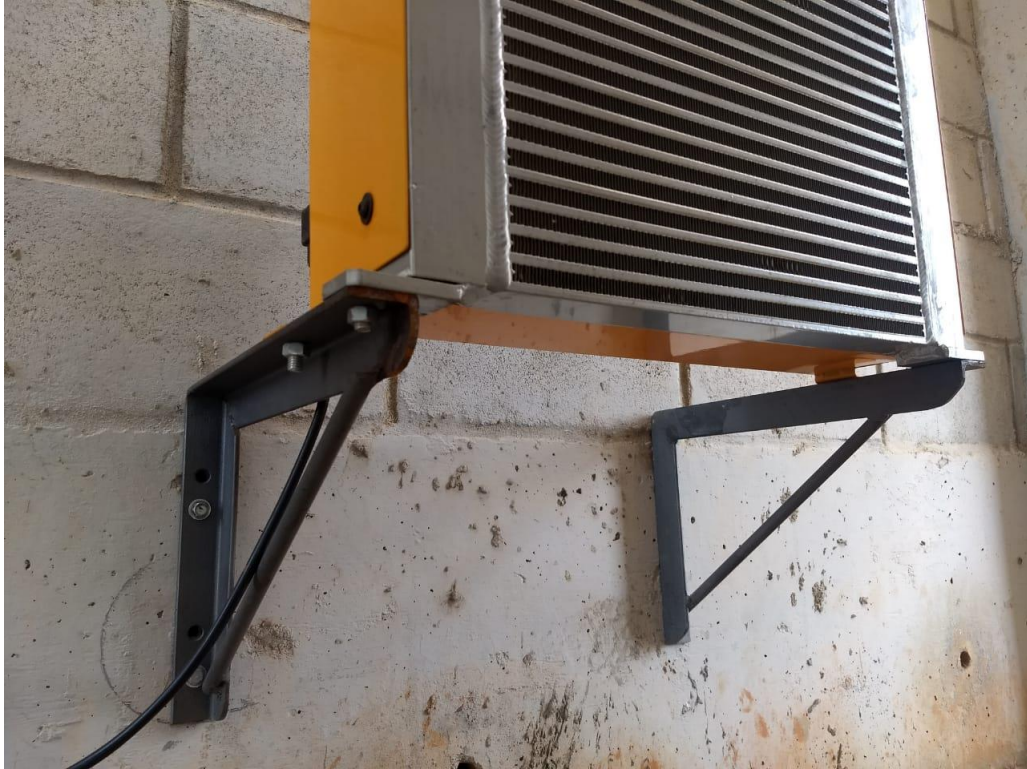
Figura 14 - Suporte para sustentação do resfriador
