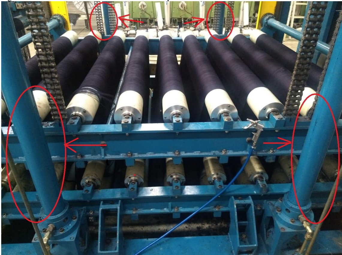
Figura 11 - Cilindros hidráulicos do acumulador de pressão
