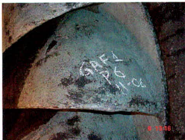
Figura 10. Pá nº6 da Turbina Francis (G1) – Usina de Gafanhoto – MG Fonte: CEMIG - Gerência de Manutenção mecânica da Geração.
