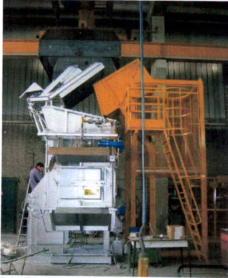
Figura 2 – Forno para fusão do alumínio
