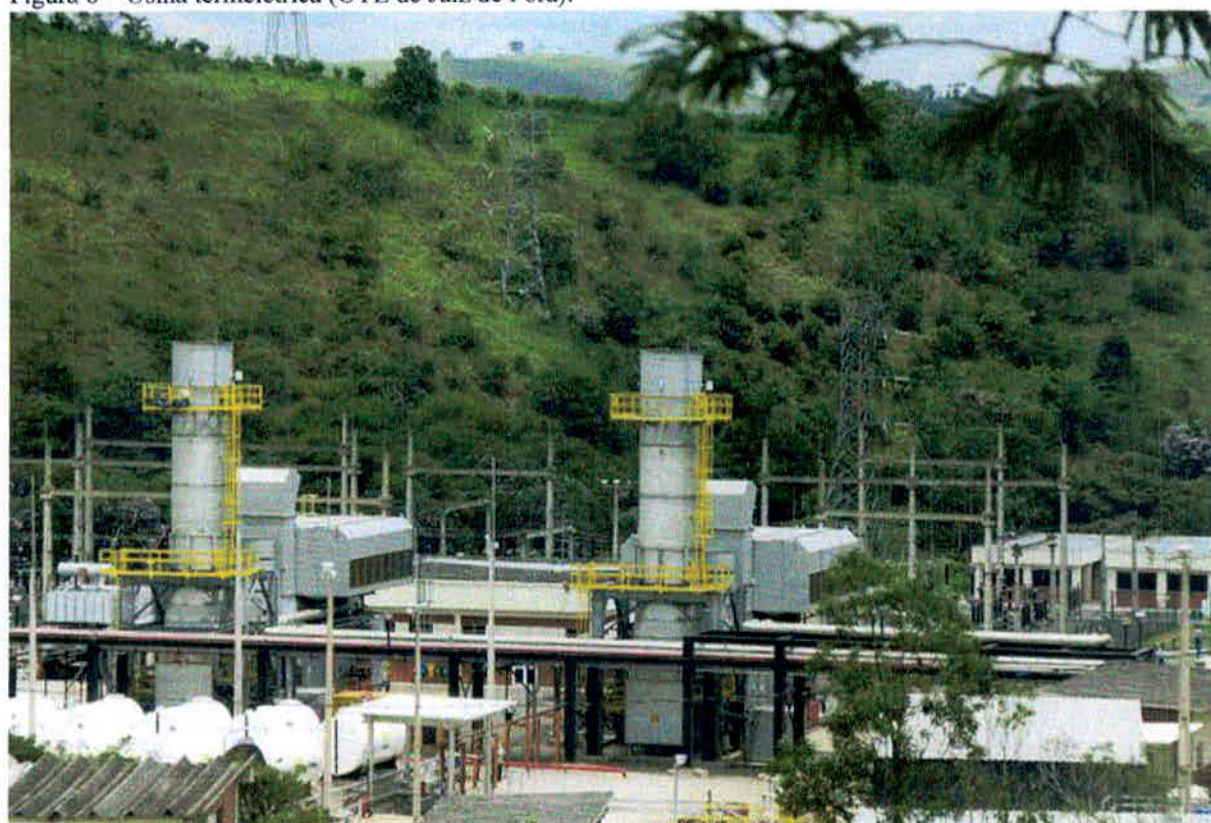
Figura 6 – Usina termelétrica (UTE de Juiz de Fora).
