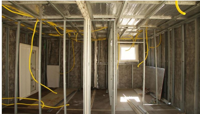
Figura 18: Instalações elétricas na casa container.
