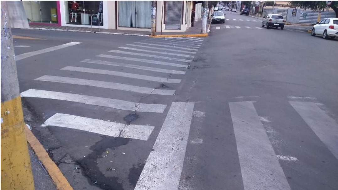
Figura 25 – Sarjetão coberto com revestimento asfáltico no cruzamento da Rua do Mercado com a Av. Getúlio Vargas
