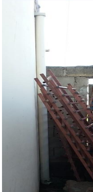
Figura 11 - Condutor vertical a direita.
