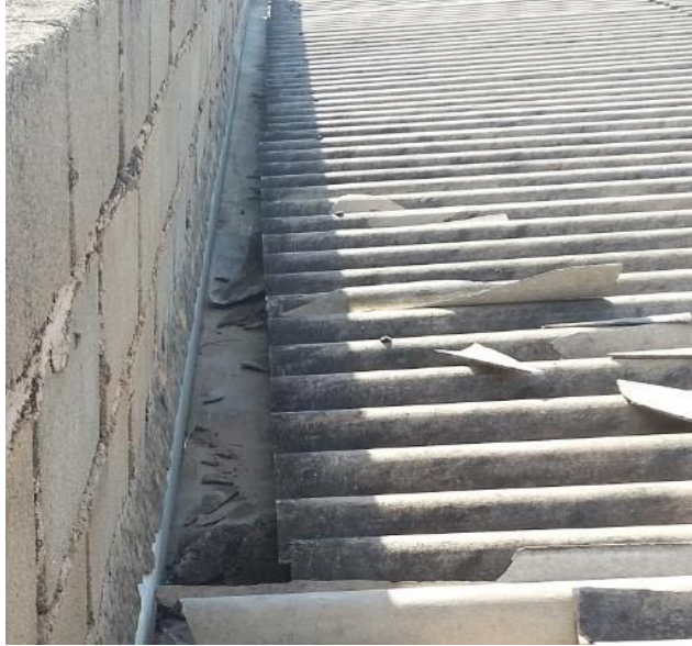
Figura 7 - Condutor horizontal em aço galvanizado.
