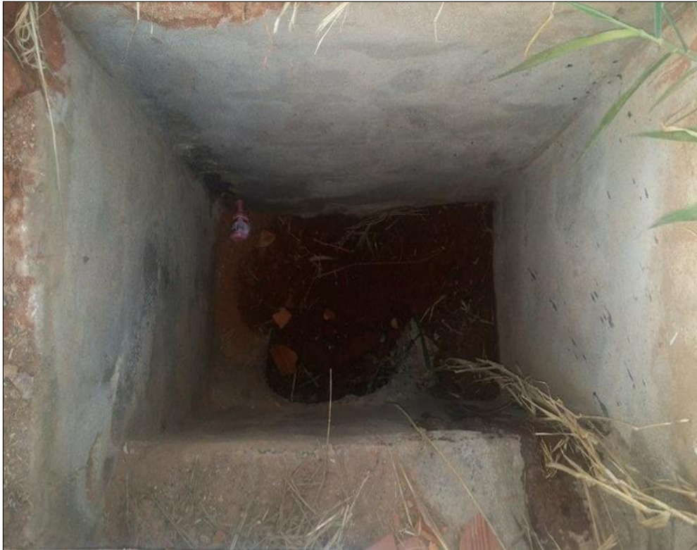
Figura 16 – Situação da caixa da boca de lobo
