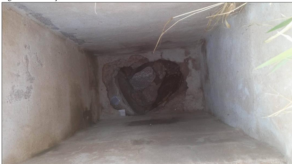
Figura 15 – Situação da caixa da boca de lobo
