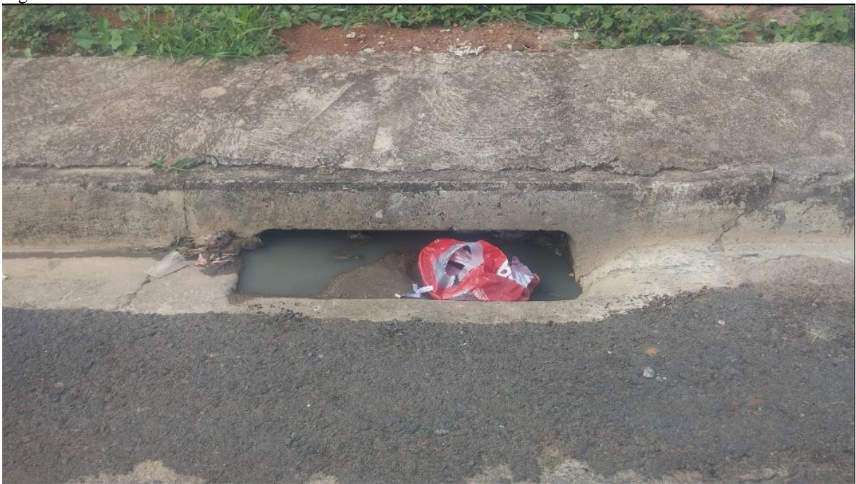
Figura 11 – Boca de Lobo obstruída
