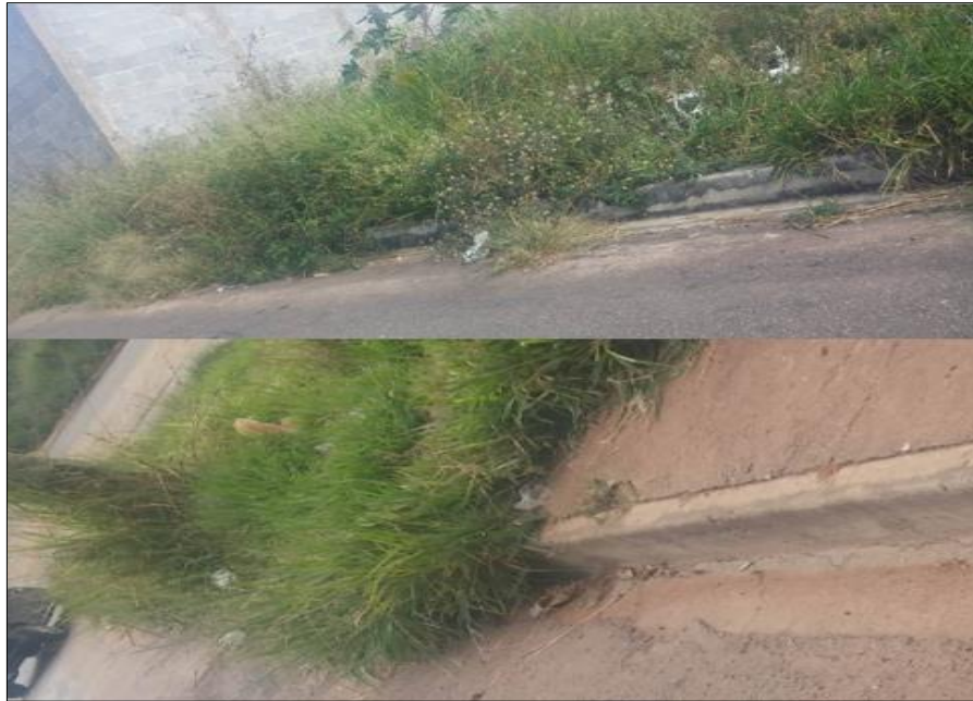
Figura 05 – Condições das sarjetas
