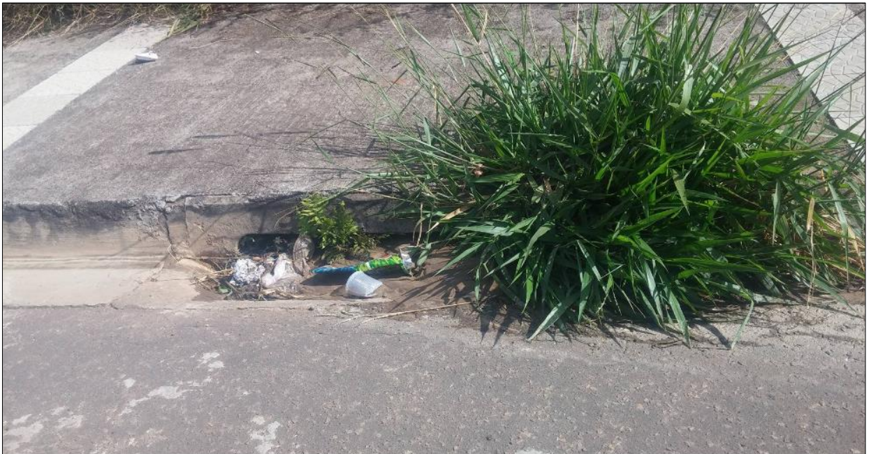
Figura 09 – Boca de Lobo obstruída
