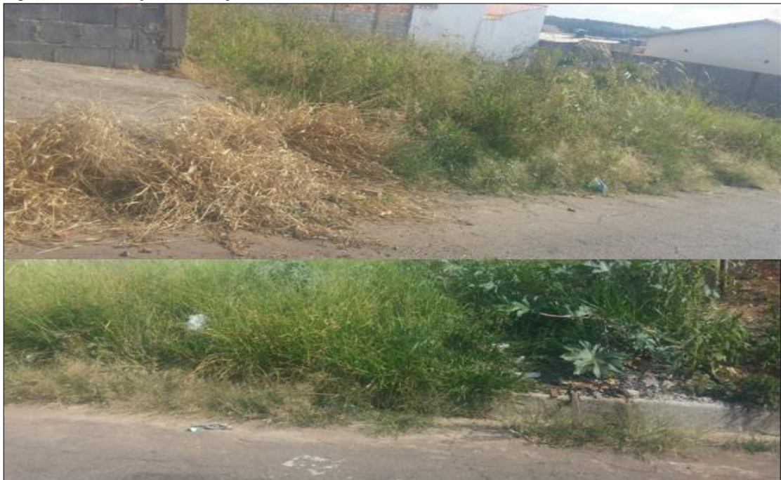
Figura 04 – Condições das sarjetas
