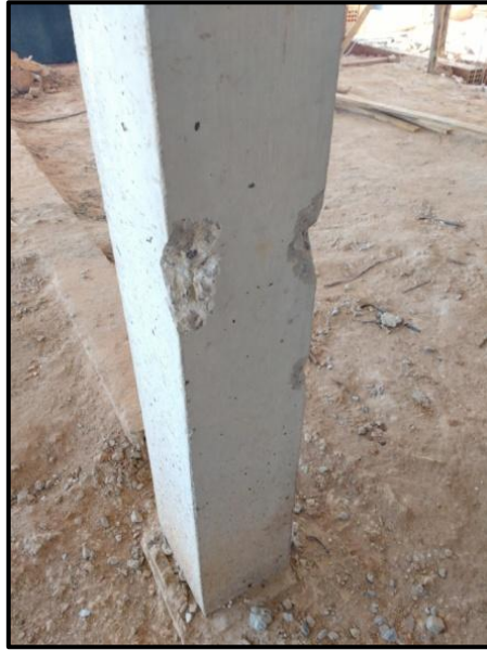
Figura 9 – Pilar curado com deformidade na superfície.
