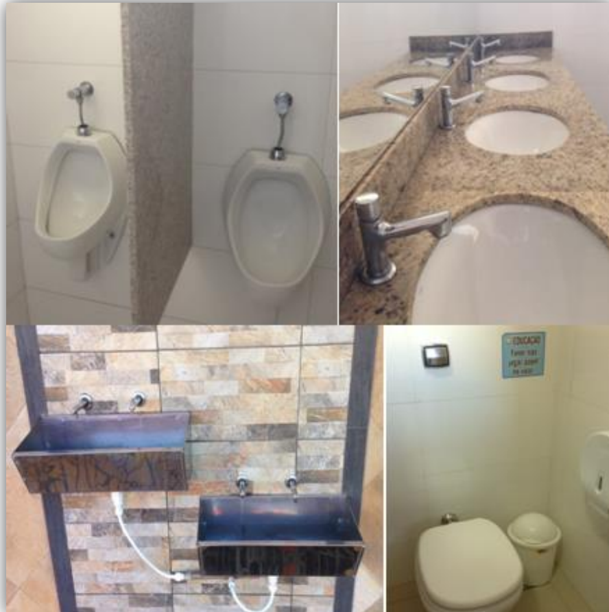
Figura 11: Aparelhos sanitários existentes na escola.
