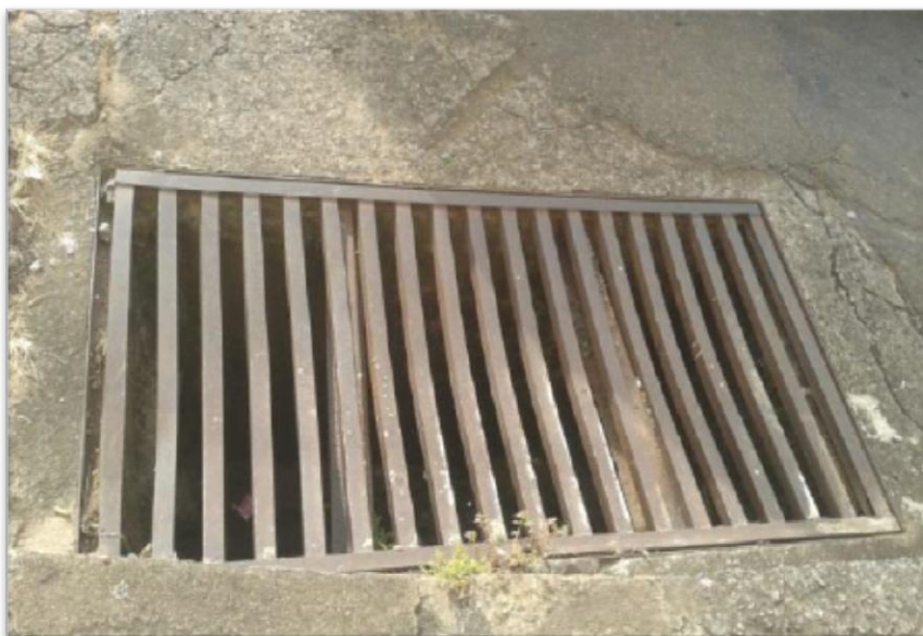
Figura 15: Boca de lobo tipo caixa com grelha em aço
