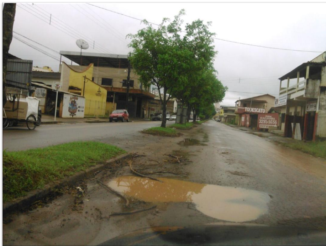
Figura 21: Voçorocas na pavimentação da Av. Dr. Renato Azeredo
