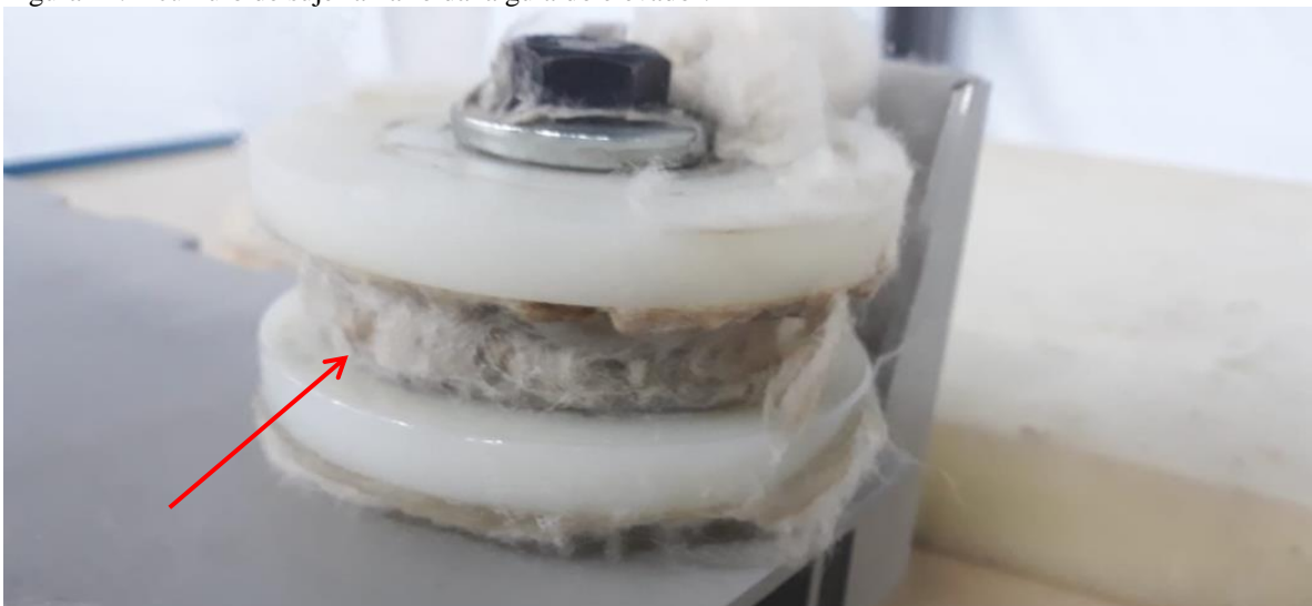
Figura 24: Acúmulo de sujeira na roldana guia do elevador.
