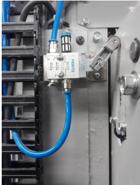
Figura 33: Fixação da válvula de acionamento do sistema.
