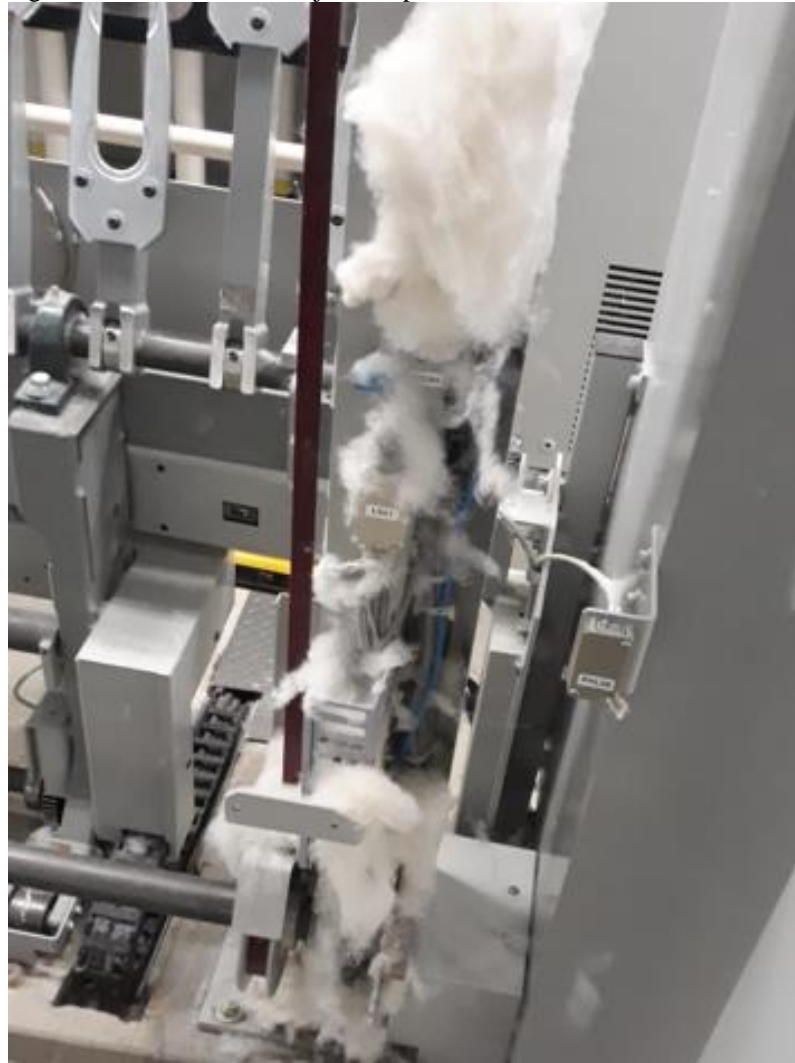
Figura 26: Nível visual de sujeira no pilar do elevador.
