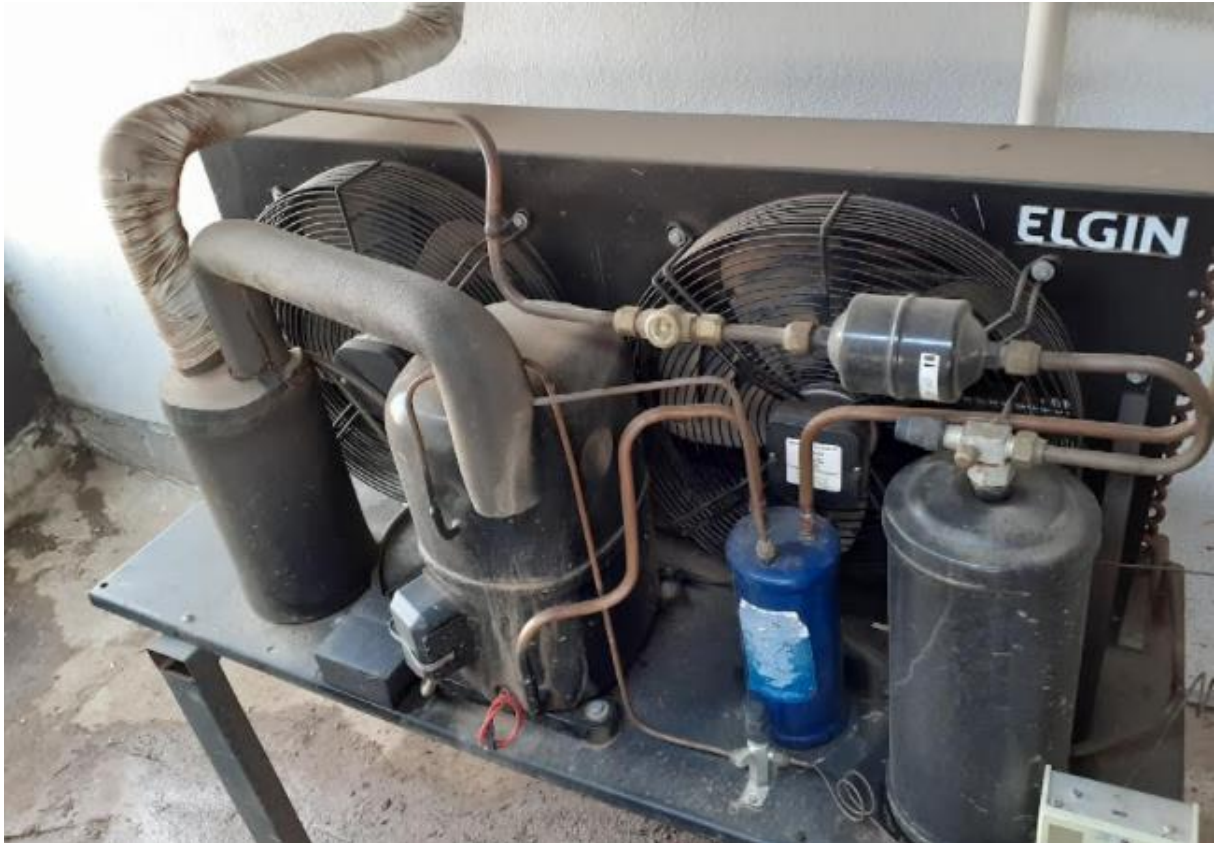
Figura 5: Sistema de refrigeração da câmara frigorífica de congelamento.
