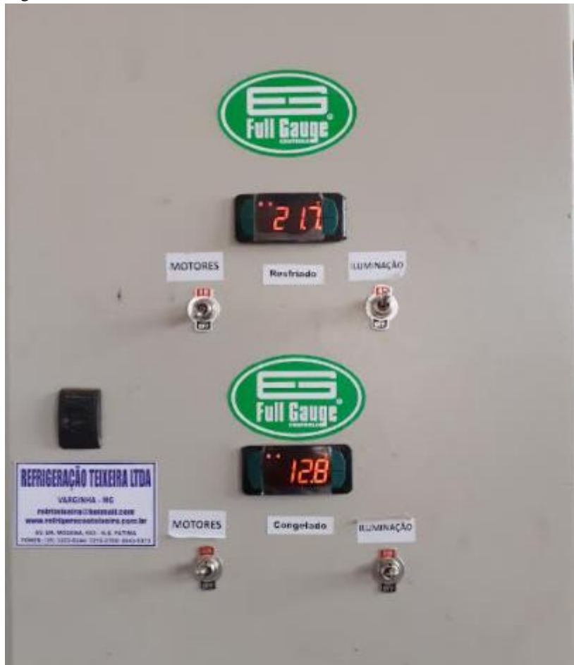
Figura 13: Paineis de Controle.
