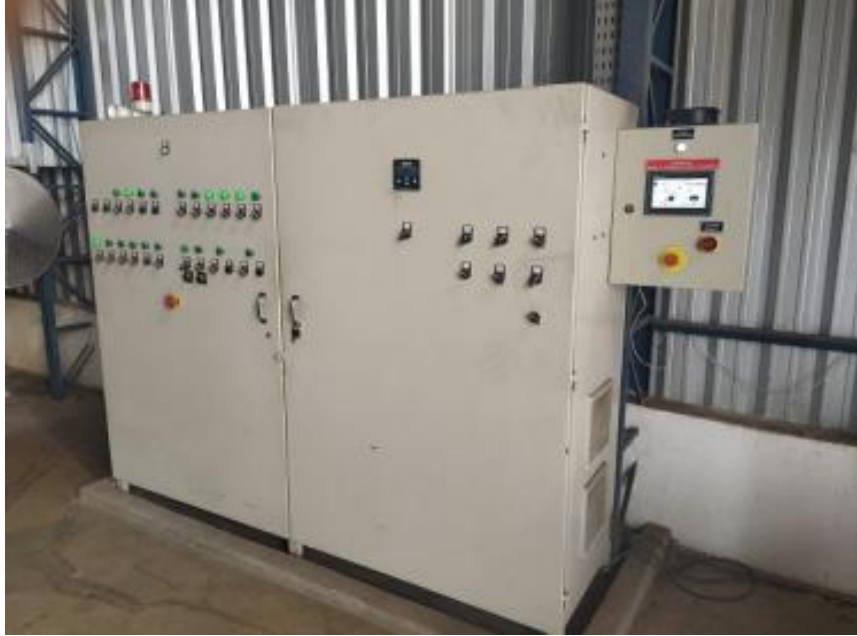
Figura 13: CLP (controlador logico programável).
