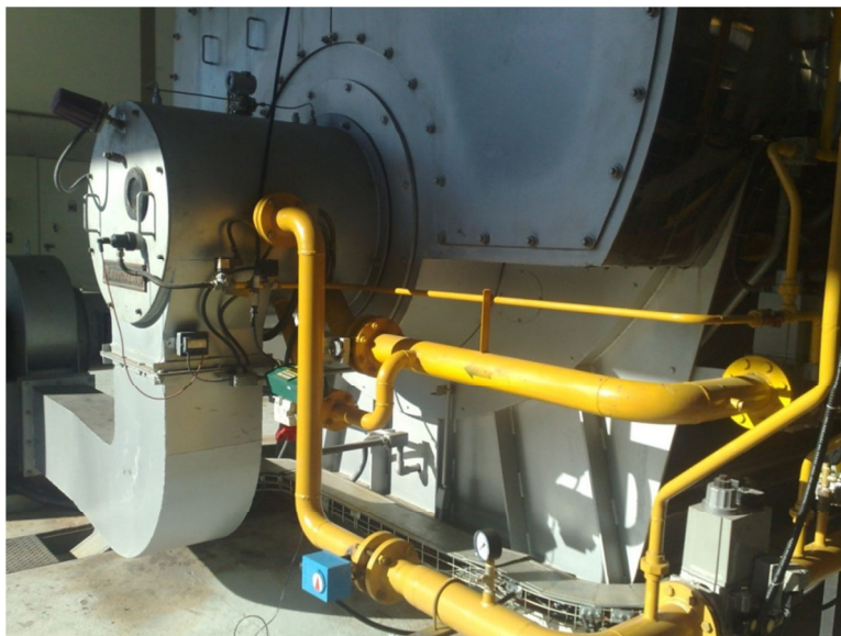
Fotografia 7: Caldeira após a instalação da rampa independente de biogás (tubulação amarela abaixo).
