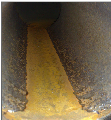
Fotografia 9: indícios de água na tubulação da rampa de biogás da caldeira
