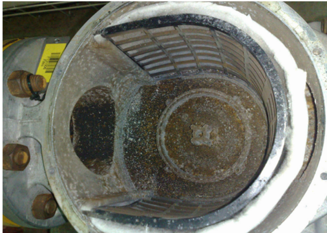
Fotografia 8: Filtro da rampa de biogás com contaminantes
