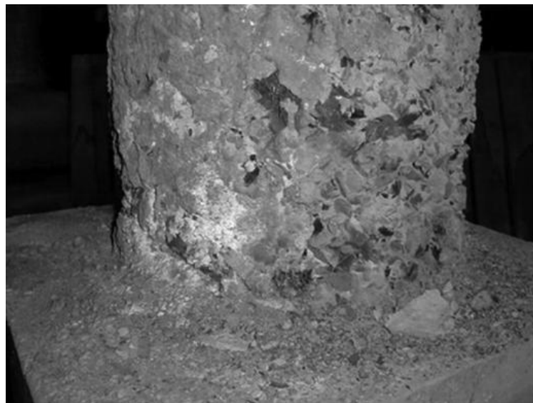
Figura 6 – Ataque de sulfato na base de um pilar de concreto armado
