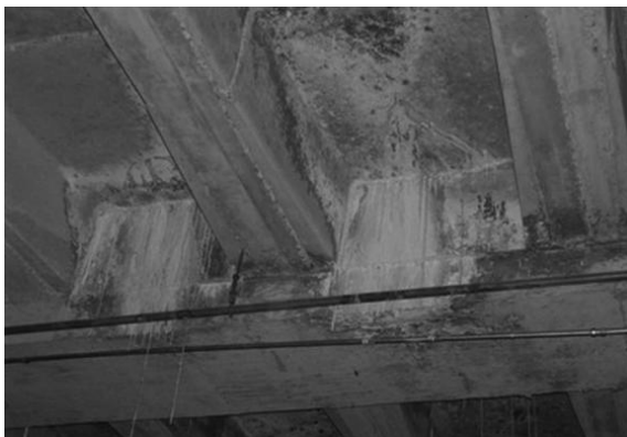
Figura 7 – Eflorescência no concreto armado
