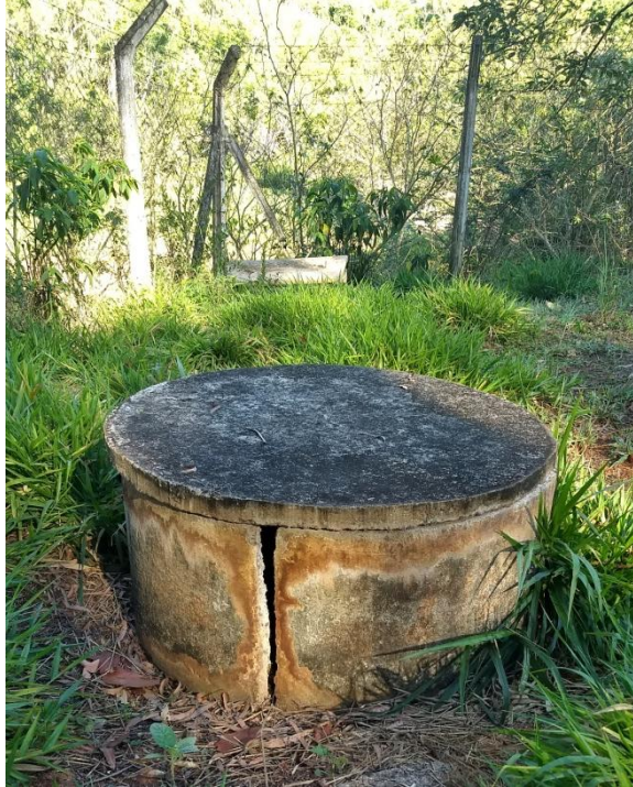
Figura 29 - Filtro de concreto com eflorescência
