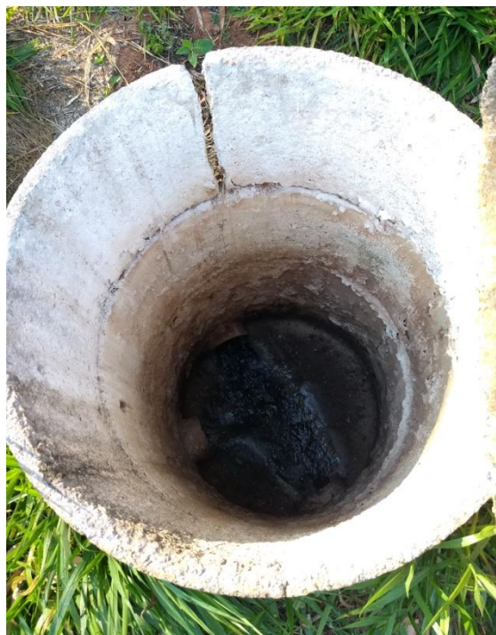
Figura 30 - Filtro de concreto com eflorescência
