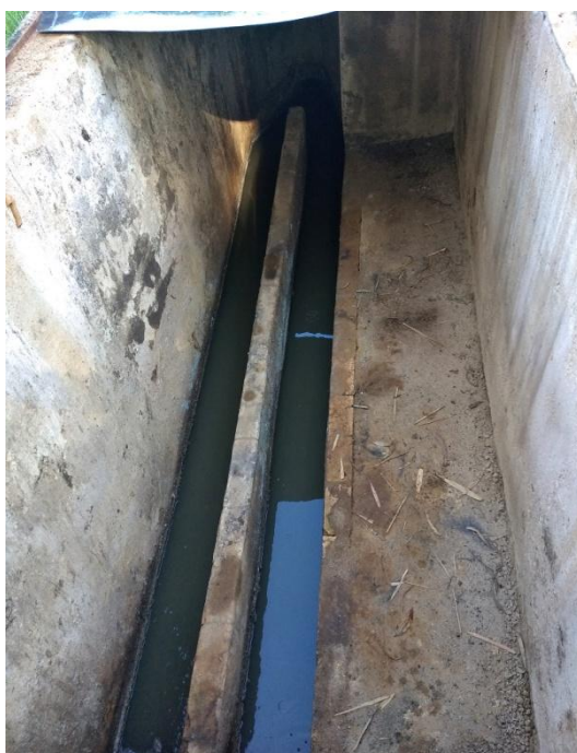
Figura 22 – Caixa de recebimento da ETE de Coqueiral - MG
