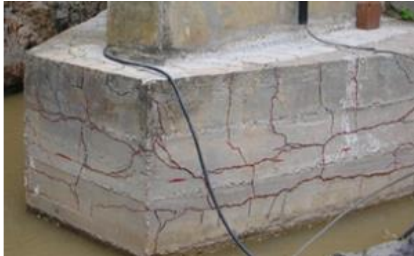
Figura 06 - Fissuras em forma de mapa em um elemento de fundação.
