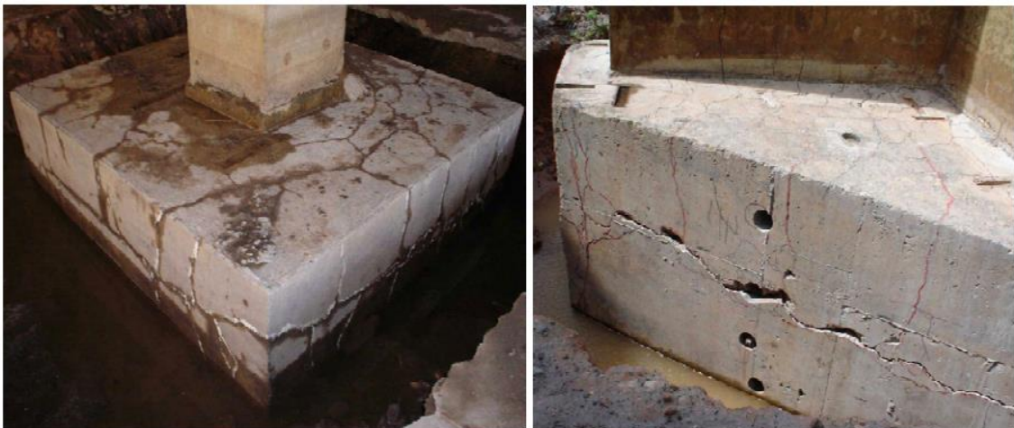
Figura 01 – Fissuração em blocos de fundação causada pela RAA.
