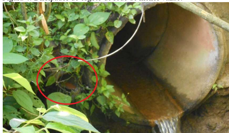
Figura 4: Dissipador de esgoto de rede de menor vazão.
