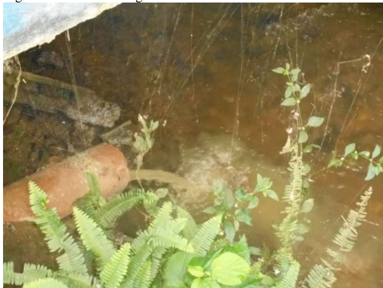
Figura 3: Descarte do esgoto da rede central.
