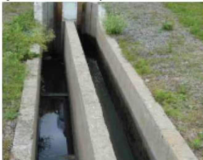
Figura 21: Desarenador de limpeza manual.
