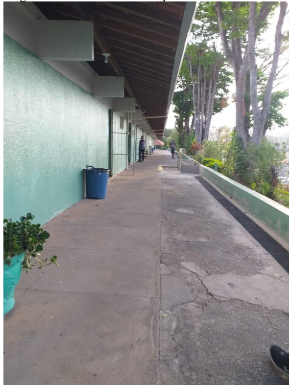
Figura 4 - Imagem do corredor da edificação ausente de sistema de prevenção
