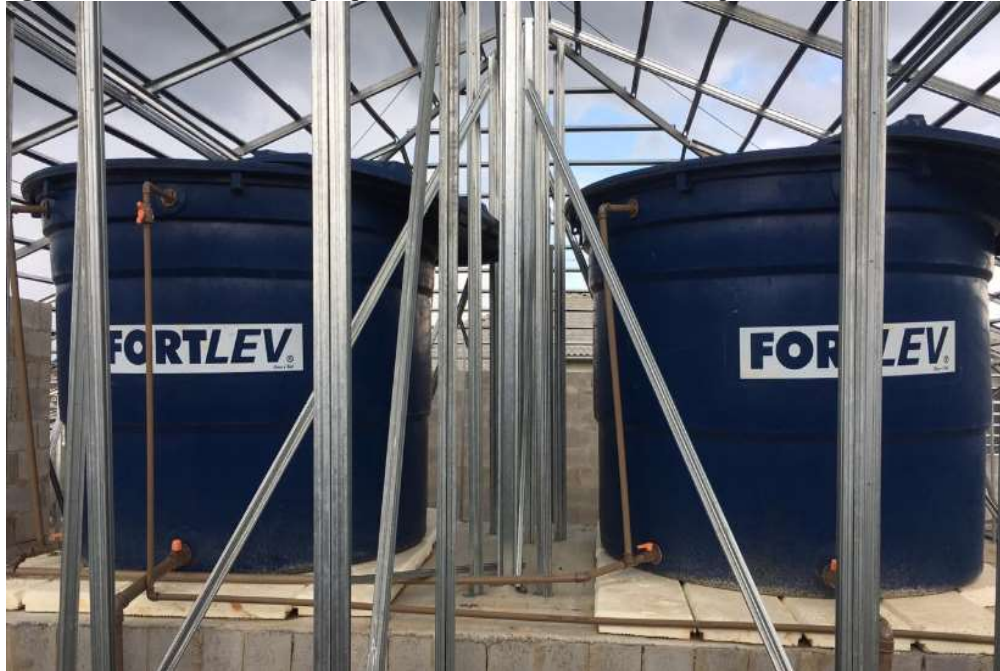
Figura 8: Reservatórios de água potável do condomínio Portal Tulipas do Campo.
