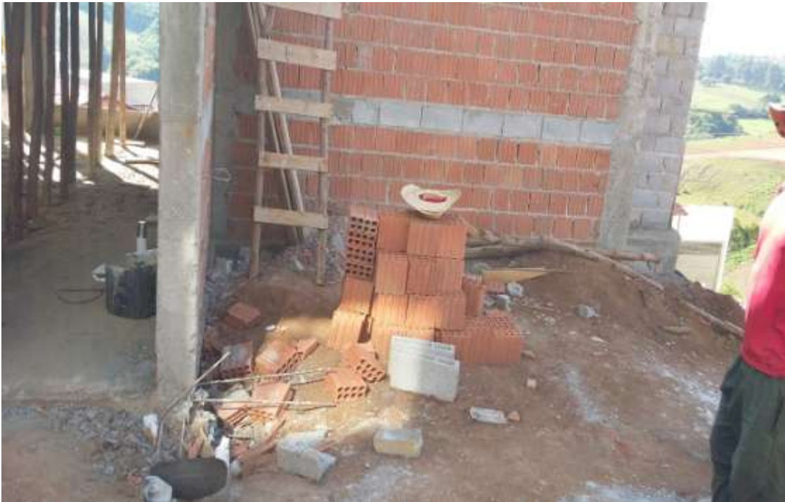
Figura 8 - Falta de organização na obra
