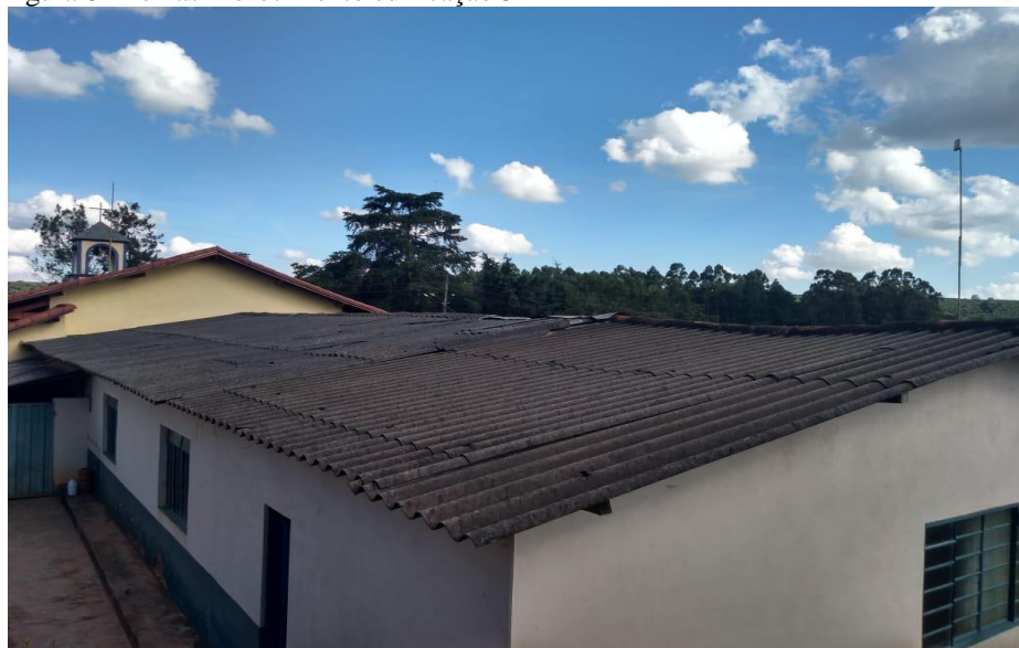
Figura 8– Telhas Fibrocimento edificação 3
