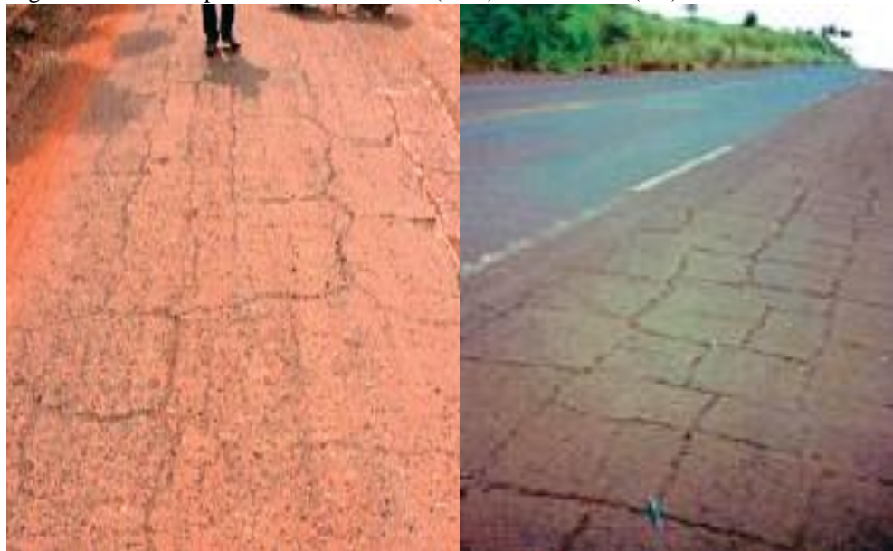
Figura 24 - Trinca tipo "Bloco" com erosão (TBE) e sem erosão (TB).
