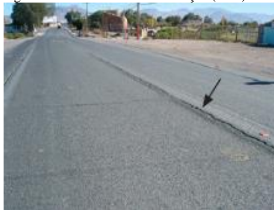
Figura 22 - Trinca isolada de retração (TRR).
