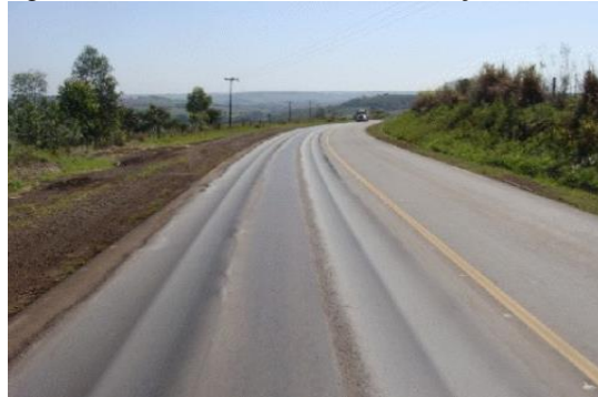
Figura 13 - Afundamento de consolidação da trilha da roda (ATC).
