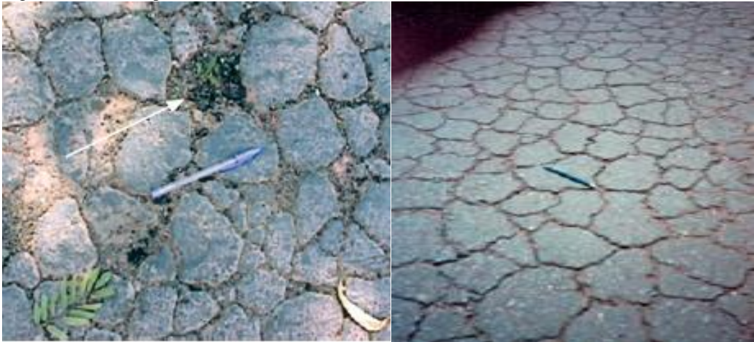
Figura 23 - Trinca tipo "Couro de Jacaré" com erosão (JE) e sem erosão (J).
