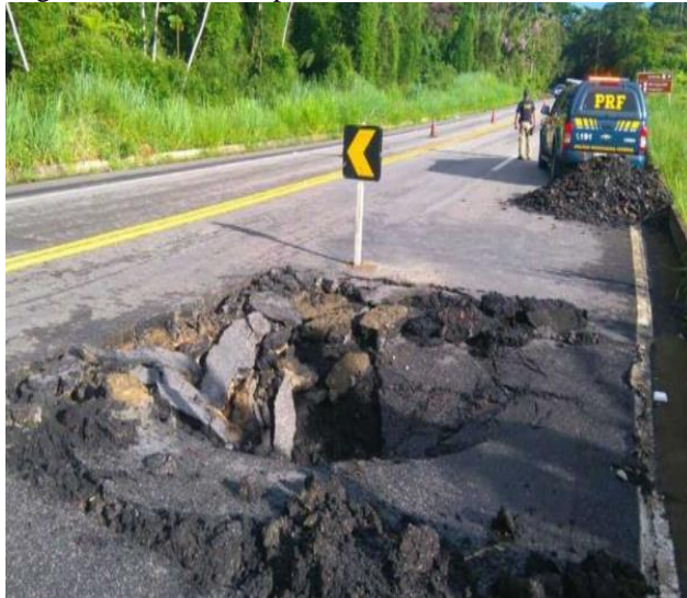
Figura 10 - Erosão na pista.
