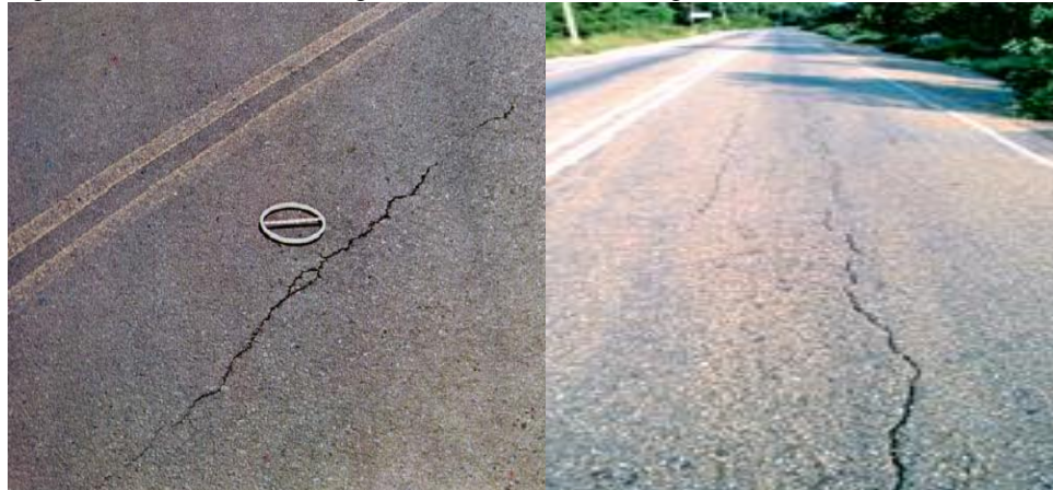
Figura 21 - Trinca isolada longitudinal curta (TLC) e longa (TLL).
