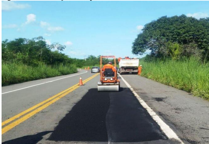
Figura 8 - Realização de tapa buraco.
