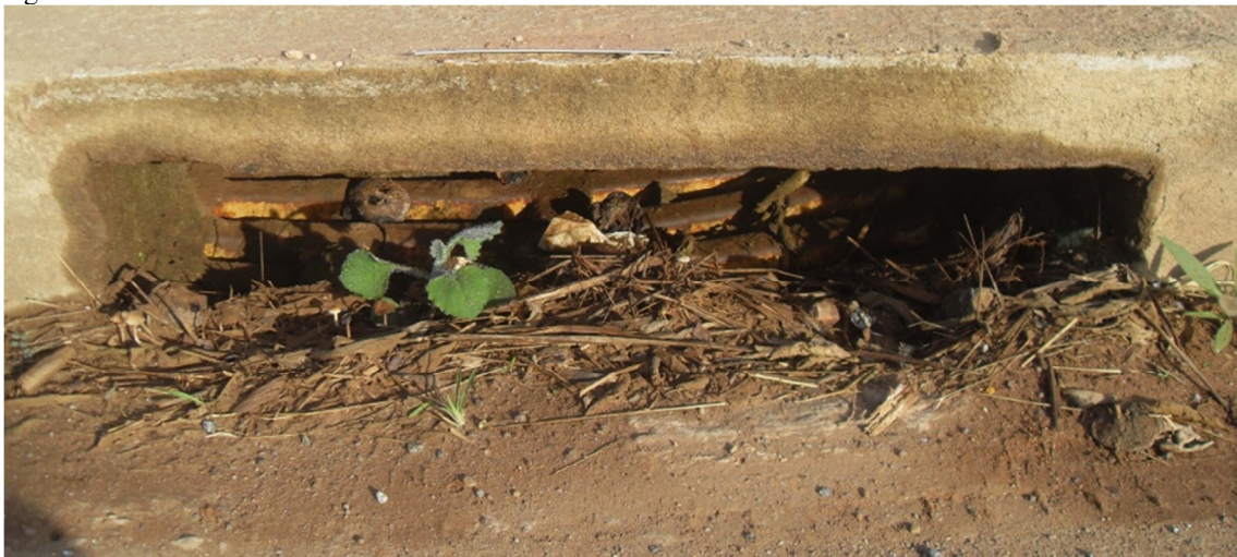
Figura 08 – Boca de lobo.
