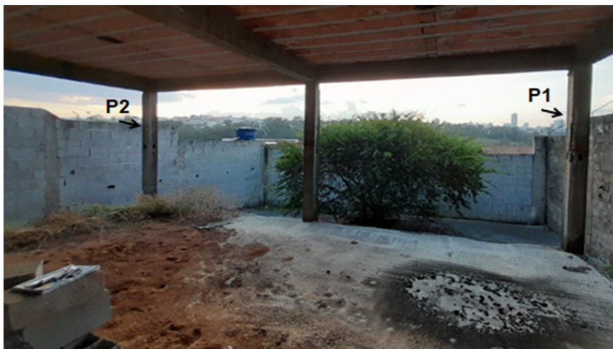
Figura 1: Estrutura da edificação com os pilares mais danificados, P1 e P2.
