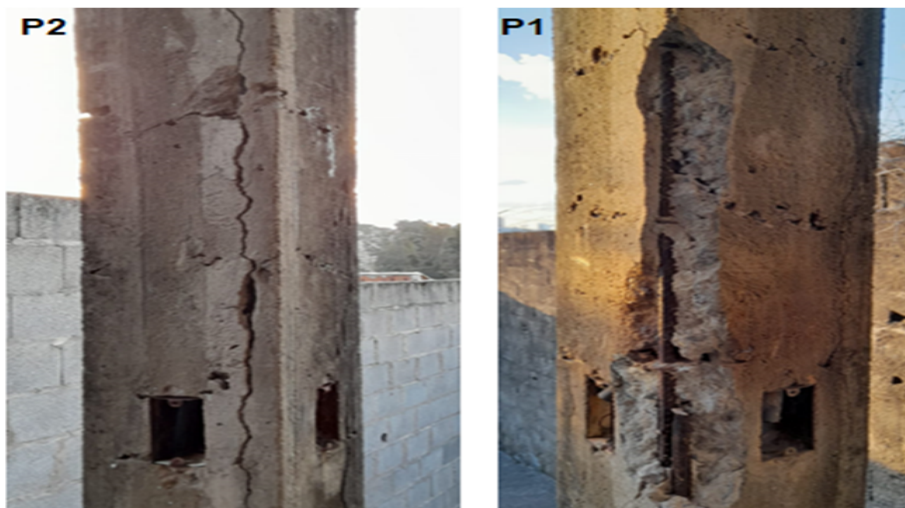
Figura 2: Pilares com deslocamentos de concreto nas suas arestas.
