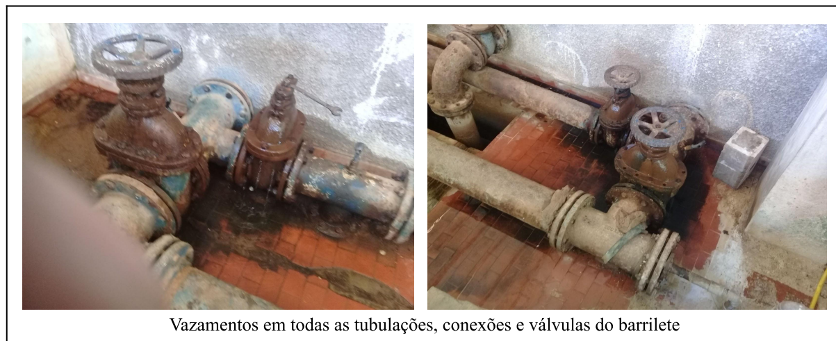
Figura 5. Barrilete da adutora de água tratada na estação de tratamento “Onofre Pinto Lara”
