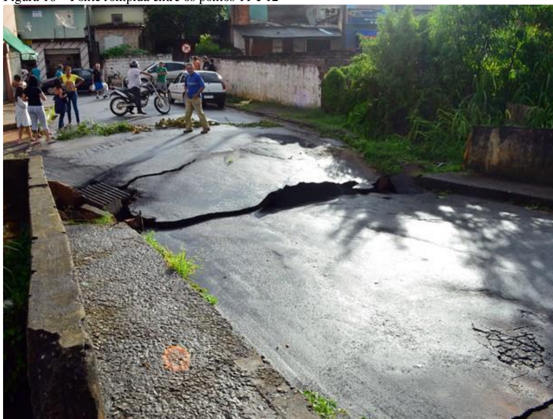
Figura 16 – Ponte rompida entre os pontos 11 e 12
